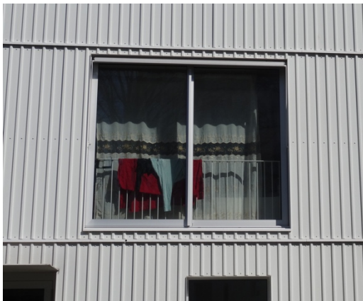
Balustrades métalliques situées derrière les grandes fenêtres dans les appartements de la Fontenette
