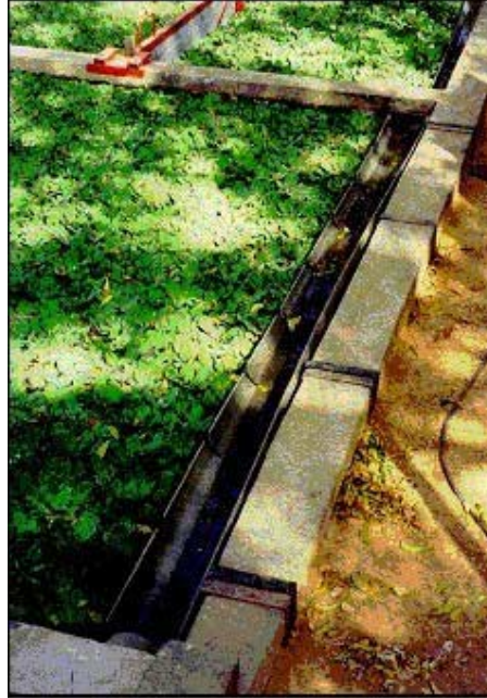
Figure 3.7 : Gouttière de répartition à l'entrée du bassin
