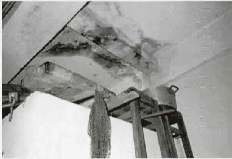
Malgré les apparences, une qualité de la construction qui laisse à désirer
