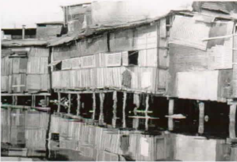
L'affaissement progressif des constructions sur pilotis
