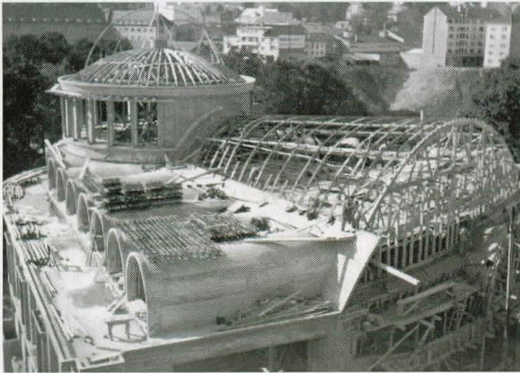
Fig. 39 Mise en place des cintres métalliques de la grande voûte, octobre 1952. – Sur les cintres de la coupole initialement prévue, on voit le gabarit de la nouvelle coupole hémisphérique. Le chevet ayant été imaginé au milieu d'un jardin à la française limité par des immeubles, Honegger l'avait conçu en conséquence. Antognini estimait qu'il fallait surélever la coupole – posée sur un tambour et non sur des claustras comme le proposait l'avant-projet –, pour qu'elle fût visible du boulevard, d'autant plus qu'on reprochait volontiers à l'église son peu d'élevation. Honegger n'insista pas et choisit l'une des propositions élaborées par l'architecte fribourgeois. La solution retenue n'est pas satisfaisante, la coupole étant quoiqu'il en soit toujours trop basse pour se détacher de l'église.
