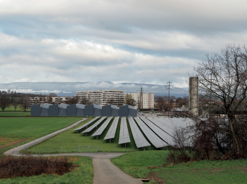
La centrale solaire de Payerne , mise en service en 2015
