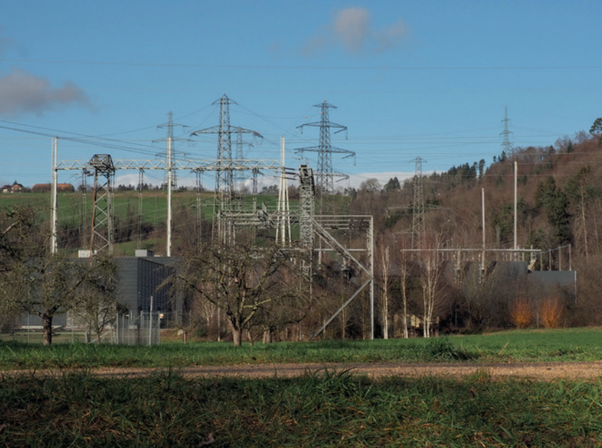
Convergence des lignes électriques sur le site de l'importante usine hydroélectrique de Mühleberg (BE).
