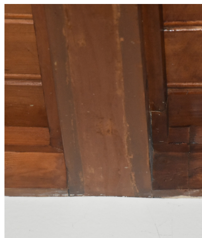
Photographie de la trace de la cloison du salon dans la poutre du plafond
