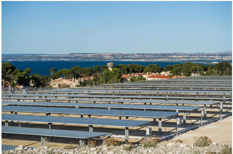
La ferme photovoltaïque. Principale transformation du site en plan, en plus de sa création d'énergie verte, elle améliore le vis- à-vis avec les logements à proximité. © Total
