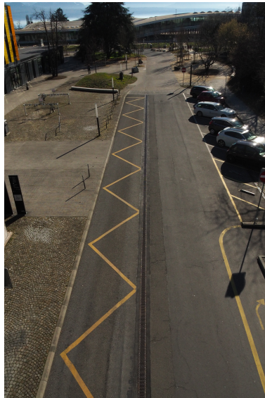
Figure 5.23: Canalisation centrale parcourant toute l'avenue Piccard.
