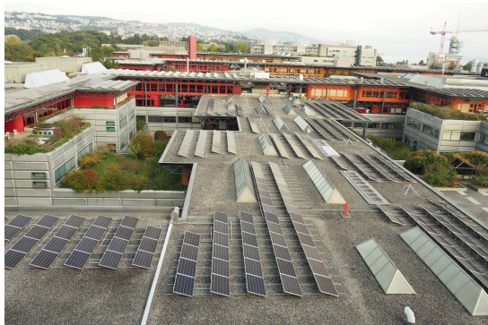
Figure 5.6: Photographie des toits plats du CM, recouverts de graviers et panneaux solaires. ©Loé Maire
