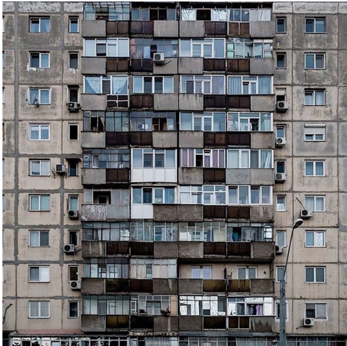
fig 43. Extrait d'une façade de bloc des années 70 situé sur l'avenue Brâncoveanu, Bucarest, Roumanie, 2017
