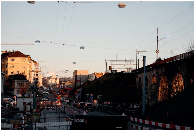
fig. 60 : photographie de la rue et des travaux pour le nouveau tram, Prilly
