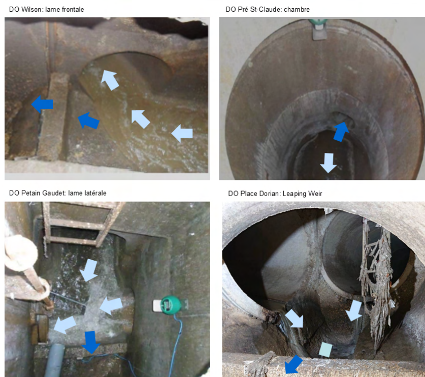
Fig. 19 – Illustration des différents types de DO du réseau d'égouts. En bleu clair l'eau restant dans le réseau, en bleu foncé l'eau déversée. Photos : manuel d'auto-surveillance, Veolia [5]
