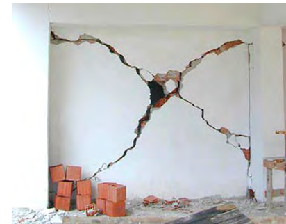
Fissures en croix dans un mur de remplissage en maçonnerie © Marc Badoux
