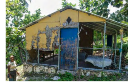
T-Shelter dégradé à Baint © B. Bourdon
