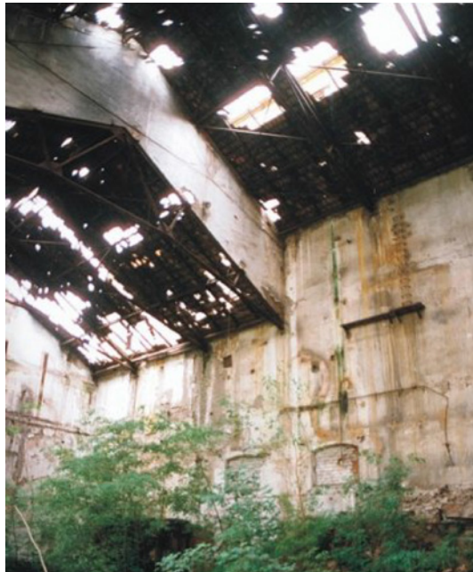
Fig. 25 ▶ État de ruine avant la restauration
