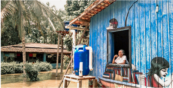
Figura 6 – Uma das cisternas instaladas na casa de uma moradora ribeirinha
