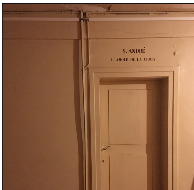
A gauche de la porte on peut voir les tirants en fer qui permettent de suspendre le plancher
