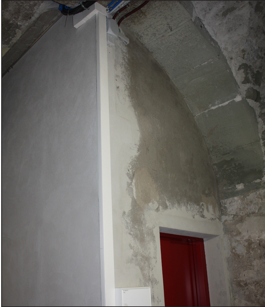
Quand le nouveau et l'ancien se rencontrent: une cage d'ascenseur en béton traversant une voûte en molasse
