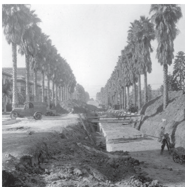
Mise en place de canalisations pour récolter les eaux de pluie sur Mariposa Avenue, 1927
