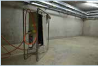
Le réseau électrique
