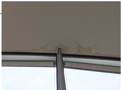
Infiltrations d'eau par la façade
