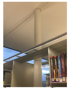
Structure en conflit avec le mobilier
