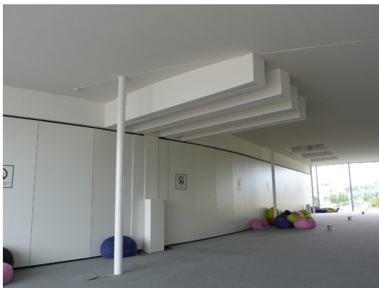
Parois mobiles de l'auditoire et système de moteur installés
