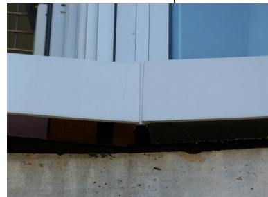
Incompatibilité du système des fenêtres avec la géométrie du bâtiment (détail)
