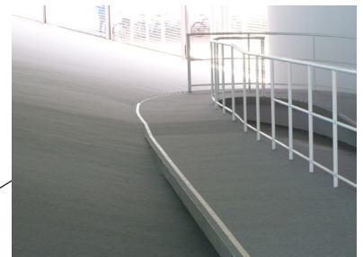
Construction d'éléments architecturaux en conflit avec la géométrie du bâtiment
