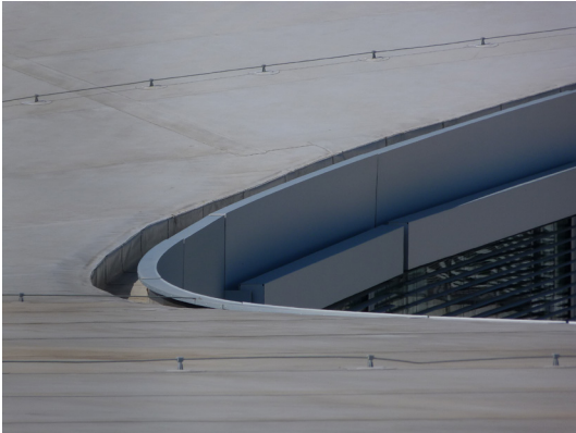
Détail du mécanisme pour la descente d'eau en toiture
