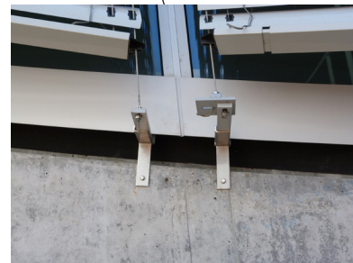
Incompatibilité des stores avec la géométrie du bâtiment (détail)
