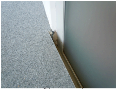
Construction d'éléments architecturaux en conflit avec la géométrie du bâtiment
