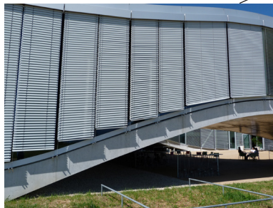
Conflit géométrique d'utilisation des stores
