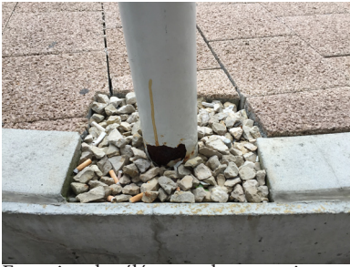
Entretien des éléments de protection insuffisant
