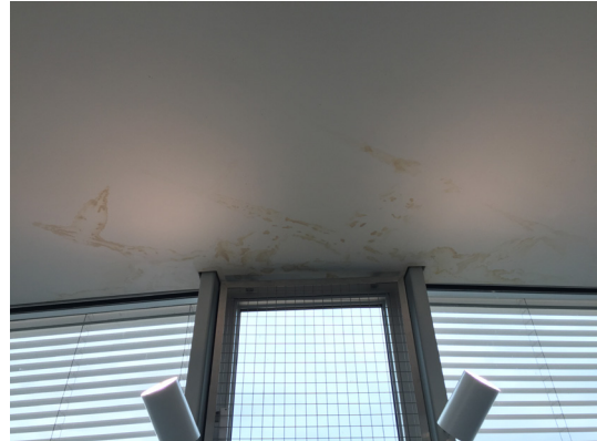
Infiltrations d'eau à cause de la descente d'eau en façade
