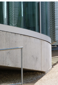
système de fenêtres du bâtiment
