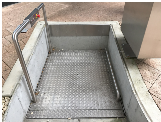
Ascenseur pour les handicapés dans un des patio
