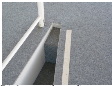
Détails constructifs en conflits
