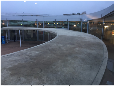
Entretien des éléments de protection insuffisant
