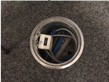
Éléments architecturaux en conflit avec l'utilisation du bâtiment
