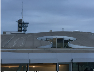
Entretien des éléments de protection insuffisant
