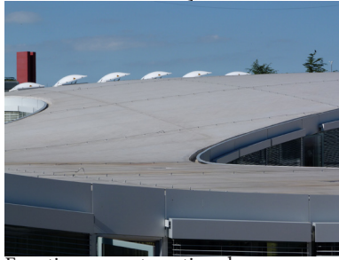
Fonctionnement continu des ouvertures zénithales
