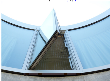
Incompatibilité du système des fenêtres avec la géométrie du bâtiment
