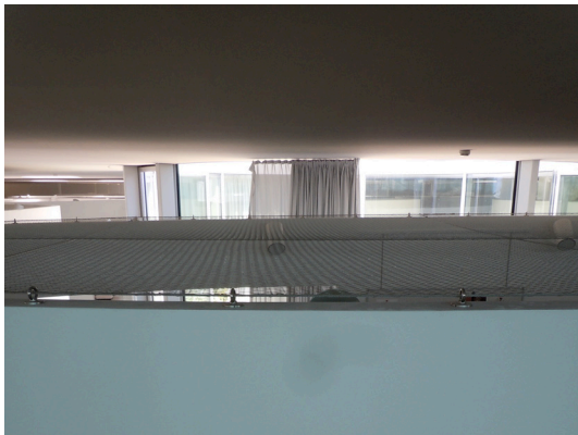
Grilles métalliques au plafond dans une des bulles de travail pour empêcher le lancement d'objets
