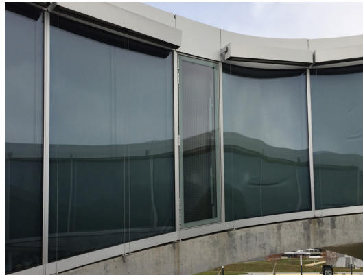
Rideaux noirs le long de la façade du patio pour obscurcir l'espace intérieur
