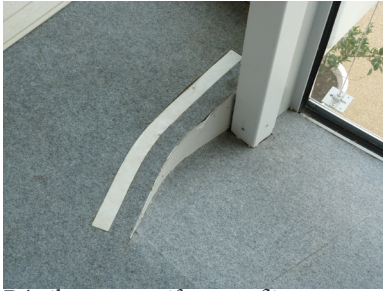
Détails constructifs en conflits
