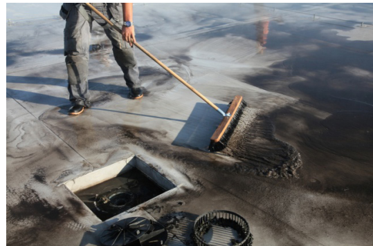
Nettoyage du toit, 2011, saleté accumulée sur le toit (© Alain Herzog)
