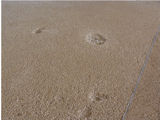
Ancien revêtement du sol extérieur et trous en surface
