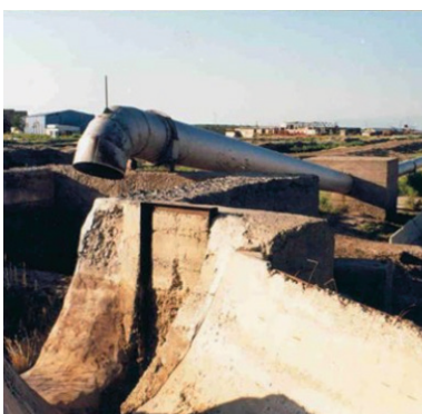
Une conduite d'eau endommagée
