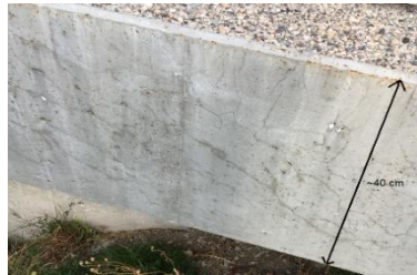
Microfissures sur les bordures en BFUP du viaduc de Cudrex.
