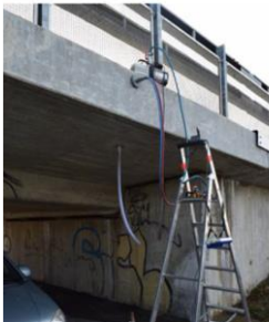
Mesures réalisées sur les bordures en BFUP à proximité de la culée côté sud.
