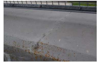
Une fissure parmi d'autres observée sur une des deux bordures en BFUP du pont à Ropraz.
