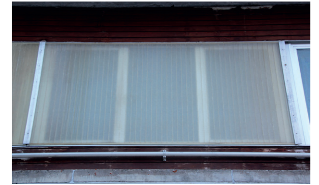
Panneaux en plastique translucide comme protection contre la neige
