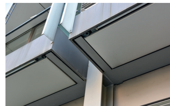
Intégration des luminaires extérieurs dans la corniche des balcons
