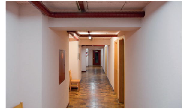
Circulation, tuyaux de ventilation au plafond et ajout pour armoire incendie.
