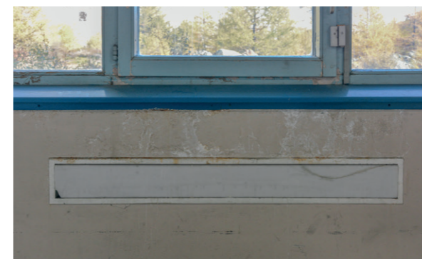
Traces d'humidité sous les fenêtres de la salle de machine
