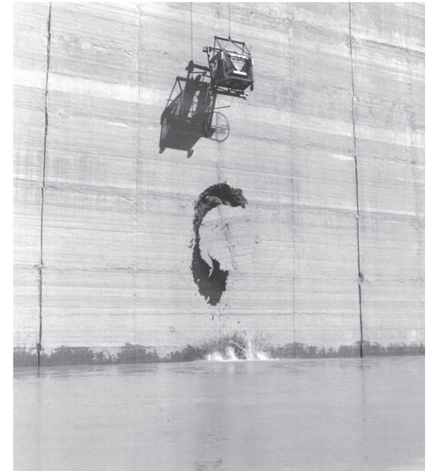
Perçement pour l'installation d'une nouvelle prise d'eau en 1998 Image : Heinz Preisig dans : Papilloud, 1999, p.182
