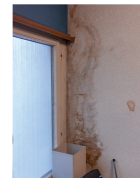
Infiltrations d'eau dans une chambre
