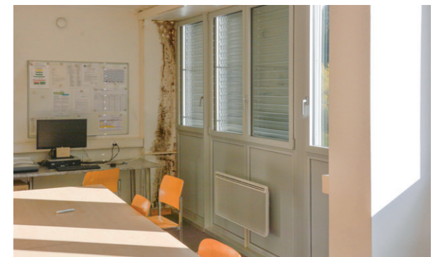
Humidité datant des anciennes fenêtres
