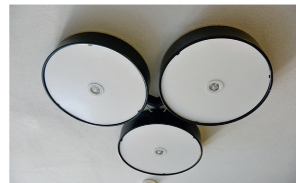
Luminaire d'origine modifié pour accueillir des spots (Z'Mutt)
