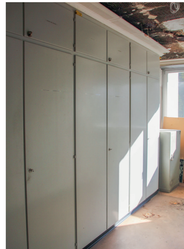
Humidité sous le faux-plafond et armoire peinte en gris
