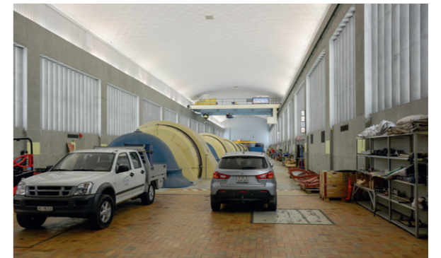
Salle des machines (Fionnay)
