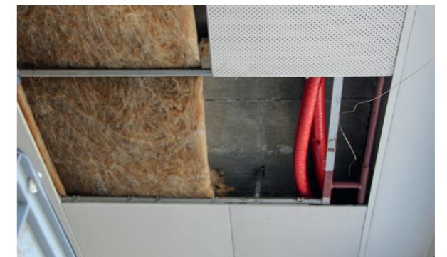
Système de chauffage dans le faux-plafond (en rouge, les nouveaux tuyaux de chauffage)
