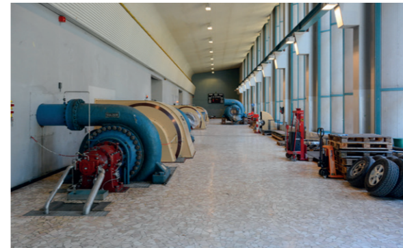
Salle des machines
