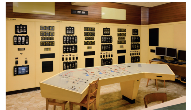
Salle de commande
