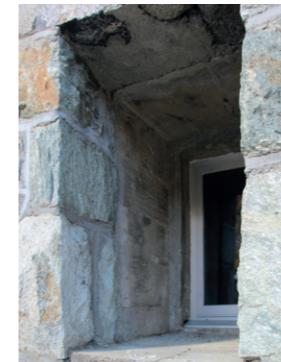
Moellons recouvrant le mur en béton
