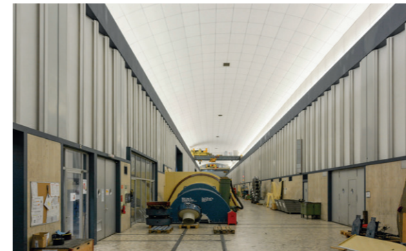
Salle des machines (Nendaz)
