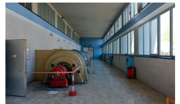
Salle des machines
