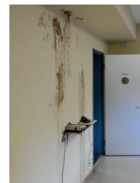
Infiltrations d'eau dans le réfectoire
