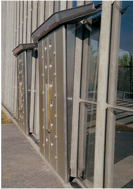
fig. 3.58 Vue détail des portes d'accès au pavillon, la porte reste d'aplomb, la façade est inclinée, 1999
