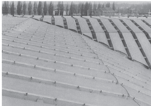
fig. 3.39 Retournement de la structure formant l'angle du nouveau bâtiment, découpe à l'onglet des éléments du pavillon, «ferme-chéneaux» et «tuile-contreventements», 1956
