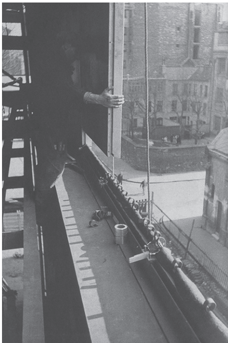
fig. 1.9 Mise en place d'un panneau de façade pendant le chantier à la Maison du peuple à Clichy, Paris, 1935-1939
