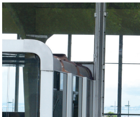
fig. 4.39 Vue de l'angle supérieur du tambour d'entrée, corrosion avancée sur les arceaux, 2016
