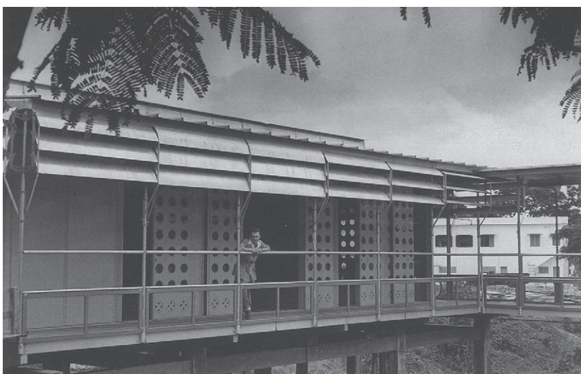
fig. 2.55 Maisons tropicales à Brazzaville. Chantier en phase de finition, les garde-corps restent à poser, été 1951
