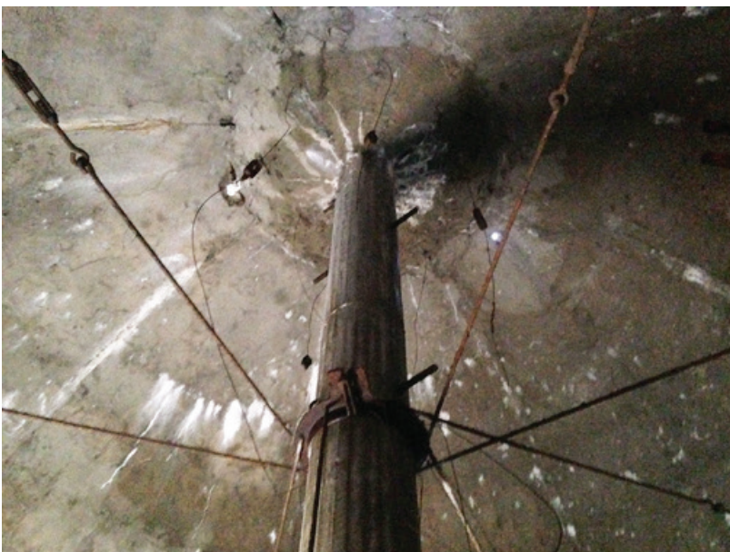
État actuel de la structure métallique du globe
