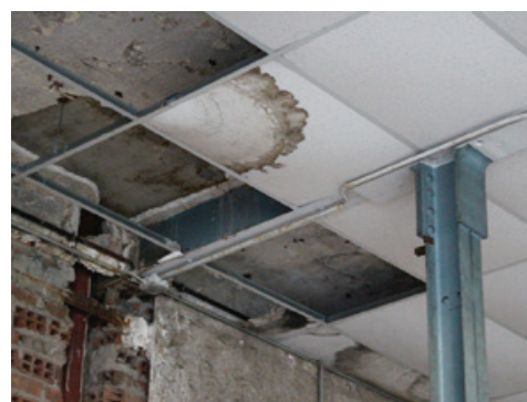
Faux-plafond dégradé par l'humidité
