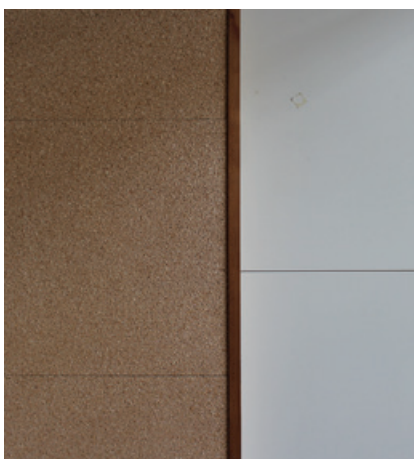
Paroi acoustique dans une salle
