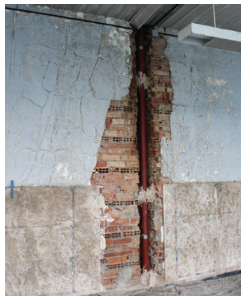
Mur abimé par la descente d'eau
