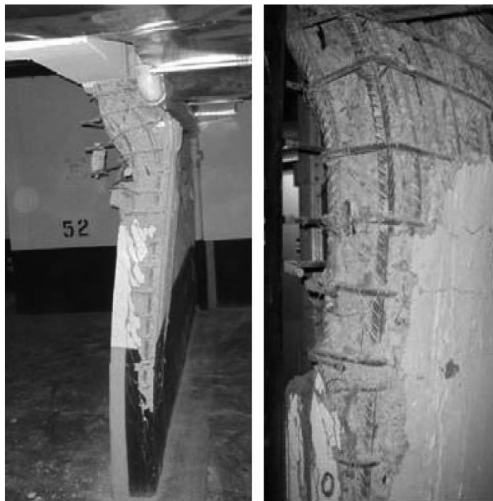
Figure 1 – Out-of-plane buckling of walls after 2010 Chile earthquake / Instabilità fuori dal piano delle pareti in seguito al sisma del 2010 in Cile (Wallace 2012)
