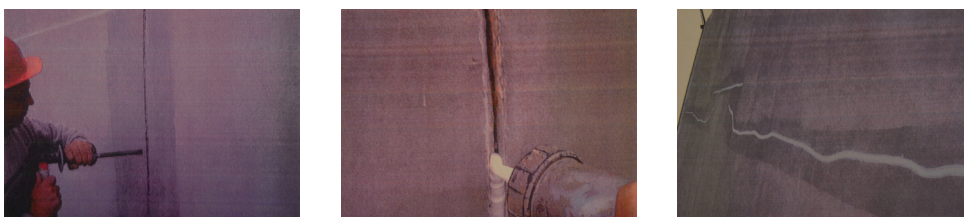
Figure 50 à 52: Réparation des fissures
