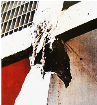
Figure 21: éclatement du béton par corrosion des armatures en acier
