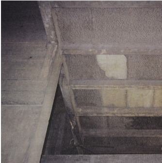
Figure 33: Vue du plafond entre les pilotis. Des décollements d'enduits sont visibles entre les poutrelles.
