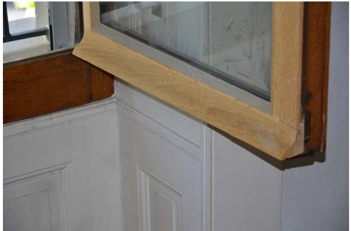
Partie basse de la fenêtre rénovée. Avant l'application de la lasure, les parties en bois ajoutées sont clairement visibles. Rue de la Gabelle 20, Genève
