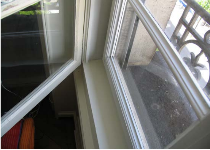
Détail de fenêtre à caisson ouverte. Les dormants de la fenêtre intérieure sont façonnés de manière à être "présentables" lorsque les ouvrants sont décrochés en été. Avenue Louis-Ruchonnet 5, Lausanne
