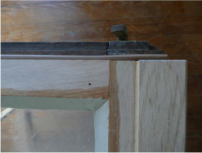
Rénovation d'une ancienne fenêtre: le double vitrage isolant est scellé avec du mastic à vitrier. Rue de la Gabelle 20, Genève
