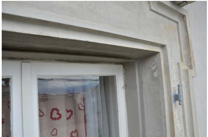
Détail de fenêtre simple. C'est surtout le cadre des ouvrants qui est perceptible de l'extérieur. Avenue d'Echallens 83, Lausanne
