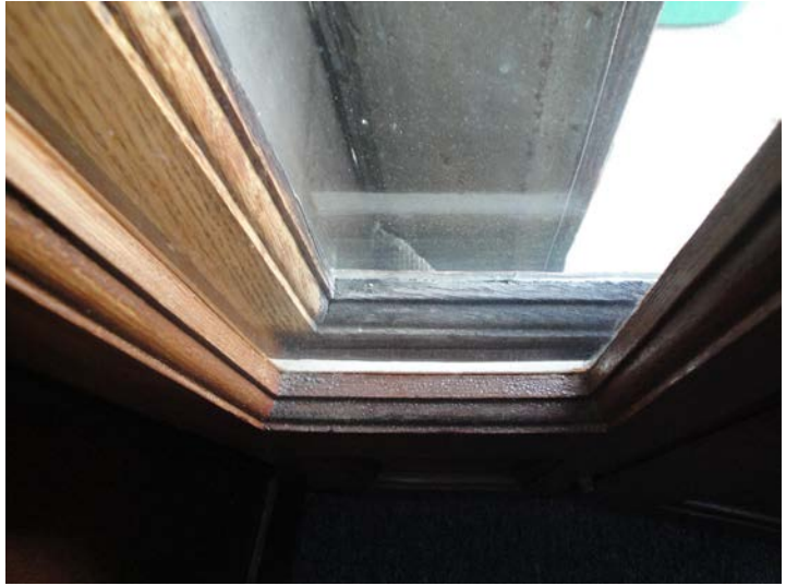
Détail de fenêtre couplée. L'espace entre les deux fenêtres est réduit au minimum. Route de Berne 7, Lausanne
