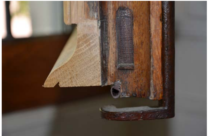
Détail de la partie inférieure d'un ouvrant: le renvoi d'eau à été changé et un joint creux en silicone ajouté. Rue de la Gabelle 20, Genève
