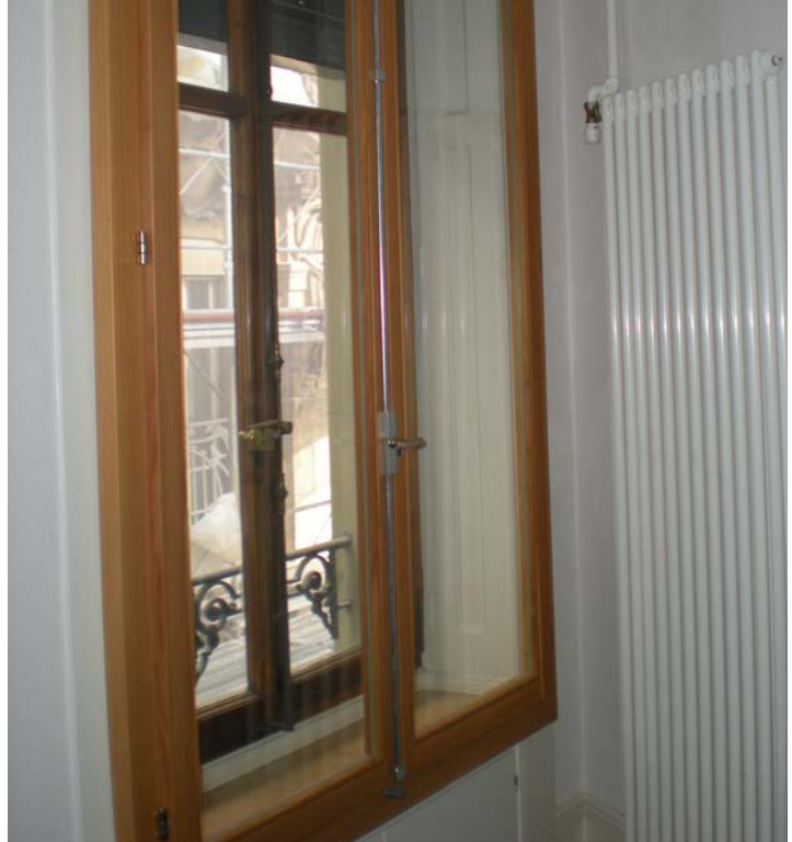
Vue intérieure d'une fenêtre doublée à l'intérieure. Rond-Point de Plainpalais 4 (source: Frei & Stefani, architectes)
