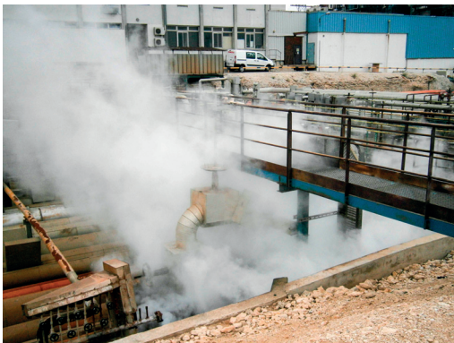
(d) Unidentified leak.
