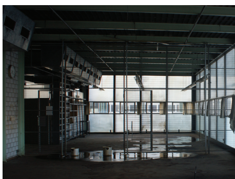
177 Vue intérieur au 3ème niveau: les infiltrations d'eau sont manifestes
