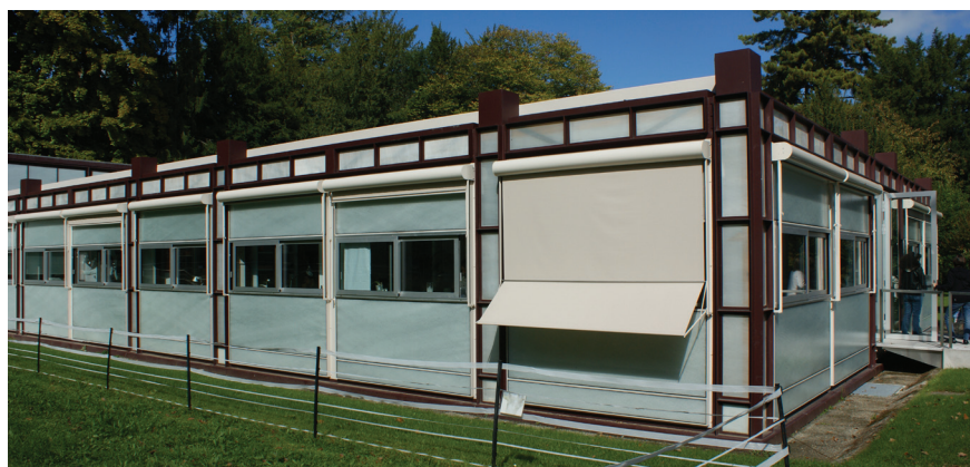
170 Vue extérieure après rénovation: l'ajout de stores extérieurs, les proportions trapues des cadres de fenêtre en aluminium et la perte de relief en façade détériorent l'aspect du bâtiment
