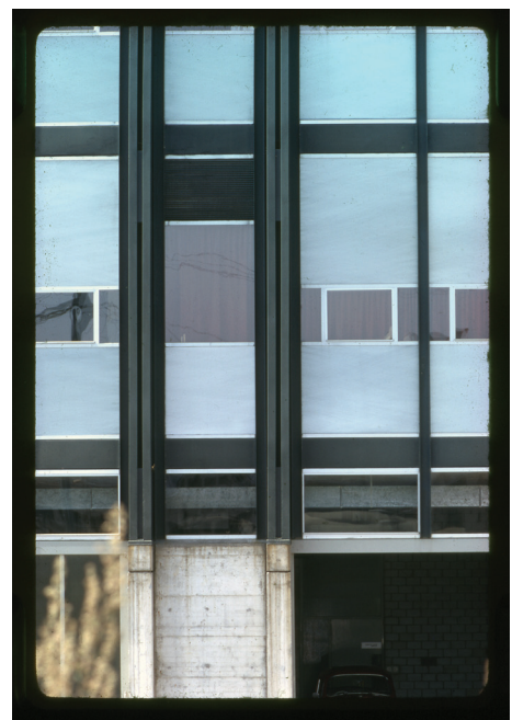
77 Le système de ventilation s'exprime en façade au niveau de la travée structurelle
