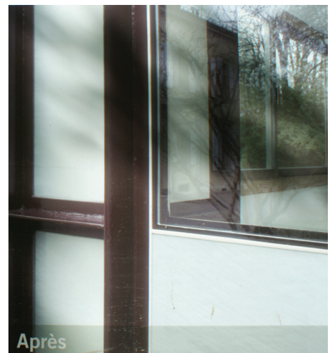
166 Etat après intervention tel que réalisé: la feullure et la parclose ont disparu.
