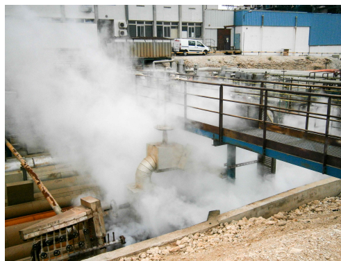
(d) Unidentified leak.
