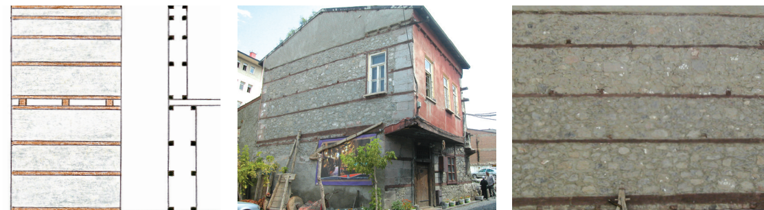
Fig.88 Réduction progressive de l'espacement vertical entre les insertions dans les parties supérieures du bâtiment : a) Schémas en élévation et section ; b,c) Variation dans un mur en moellons (Est).
