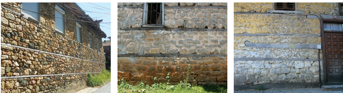
Fig.174 Constructions situées sur des types de sols différents : a, b) Sur sol rocheux (Vevçani, Lin) ; c) Sur sol souple (Struga).
