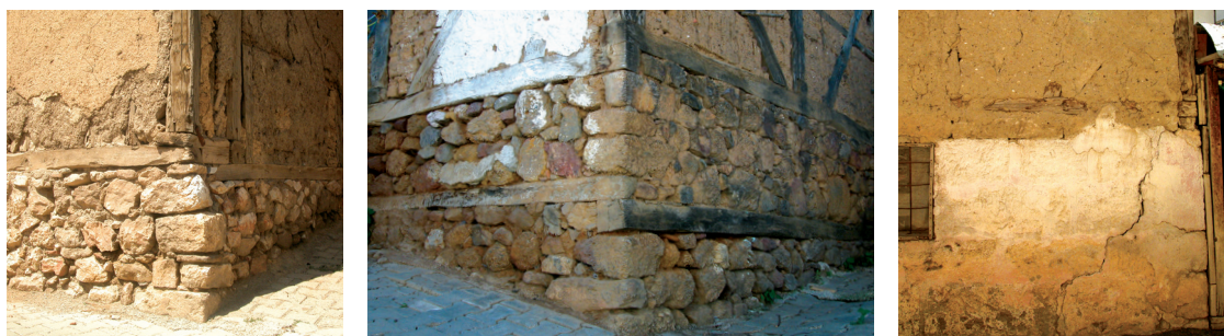
Fig.104 Soubassement en maçonnerie de pierre : a) Muret de faible hauteur (Centre Est) ; b) Soubassement de 2 mètres de hauteur comprenant des insertions horizontales en bois (Ouest) ; c) Soubassement sans insertions et présentant une fissure diagonale (Centre Est).
