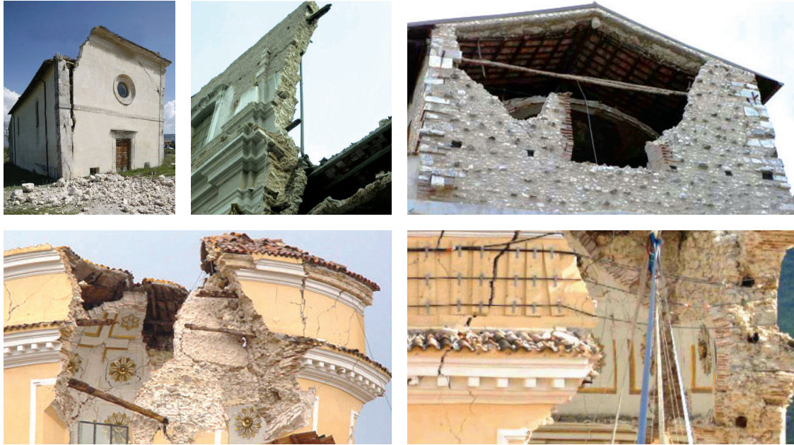
Fig.32 Monuments religieux renforcés avec des tirants en bois : a) Eglise Santa Maria degli Angeli , Civita di Bagno (Crédit : Lattanzi) ; b) Eglise Santa Maria di Paganica datant du XIV e siècle, L'Aquila (Crédit : Borri) ; c) Eglise San Biagio d'Amiternum du XVIII e siècle, L'Aquila (Crédit : Munari) ; d,e) Coupole de l'église Santa Maria del Suffragio réalisée au XIX e siècle, L'Aquila (Crédits : d, Lagomarsino ; e, Vigili del fuoco).
