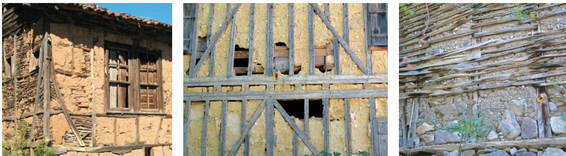
Fig.97 Différents types de remplissage en terre : a) Torchis (Ouest) ; b) Terre argileuse coulée à l'aide de coffrages (Centre Ouest) ; c) Terre graveleuse coulée entre des lattes (Est).
