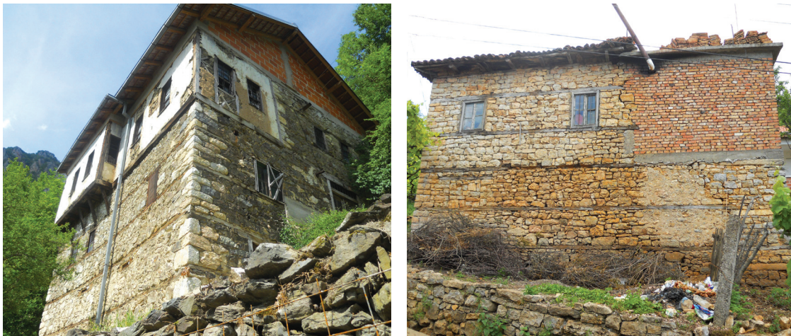
Fig.180 Interventions récentes inadaptées au risque sismique : a) Rénovation du comble en béton armé et en maçonnerie impliquant une augmentation considérable du poids et de la rigidité de l'ensemble structural (Janche) ; b) Rénovation avec des murs en maçonnerie en briques de terre cuite non armée (Lin).
