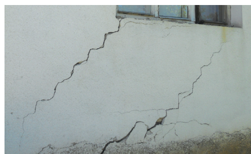
Fig.166 Fissuration diagonale dans une maçonnerie en briques de ciment dépourvue d'insertions.
