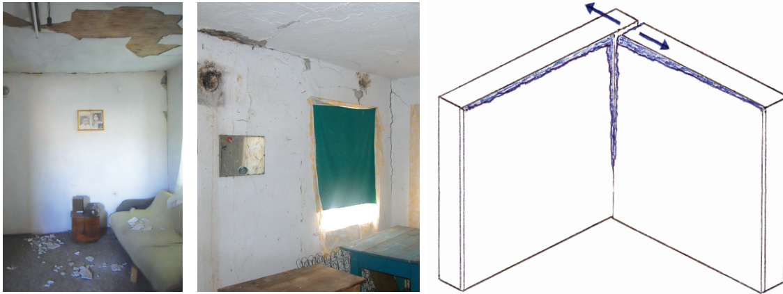
Fig.167 Détachement de l'enduit du plafond (a) et fissures à l'intersection de murs ainsi que entre ces derniers et le plancher (b) ; c) Schéma des mouvements probables de deux murs perpendiculaires à l'origine de la fissure verticale dont la dimension augmente vers le haut.
