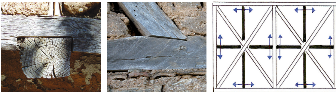
Fig.102 Assemblages ordinaires : a) Liaison entre sole basse et solive du plancher (Ouest) ; b) Liaison entre sole basse et diagonale (Ouest) ; c) Schéma : mouvements possibles en correspondance des assemblages.
