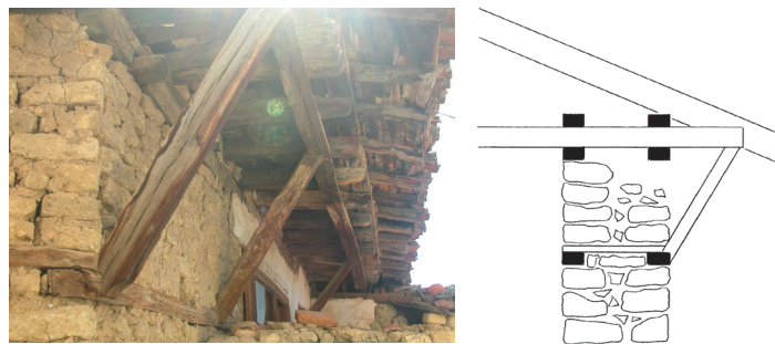
Fig.179 Jambes de force entre l'insertion et la charpente (a, Ohrid) et schéma de la situation probable en cas de renversement de la maçonnerie (b).
