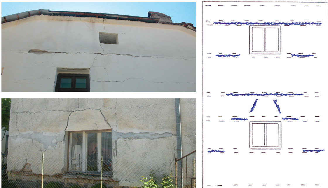
Fig.165 Fissures horizontales en correspondance des insertions avec successif détachement d'une portion de l'enduit en ciment (a) et fissures en biais aux angles des ouvertures (b) ; c) Schéma indiquant les zones de fissuration dans l'enduit extérieur.
