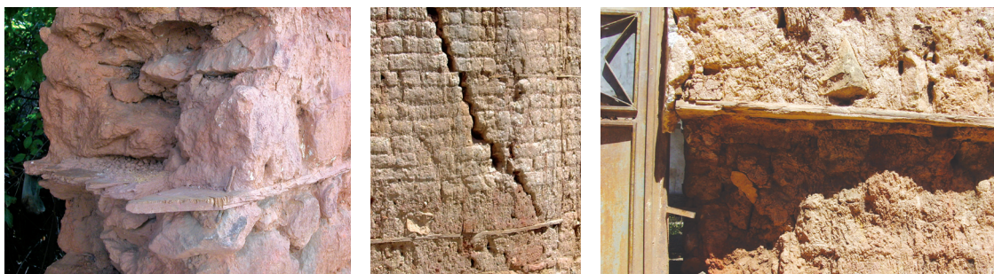
Fig.83 Planches en bois rigides : a) Plusieurs éléments juxtaposés (Centre Ouest) ; b) Efficacité dans l'interruption de fissures diagonales dans les maçonneries en briques (Centre Ouest) ; c) Fonction de linteau évitant l'écroulement de la maçonnerie en cas d'érosion des briques de terre crue (Centre Ouest).
