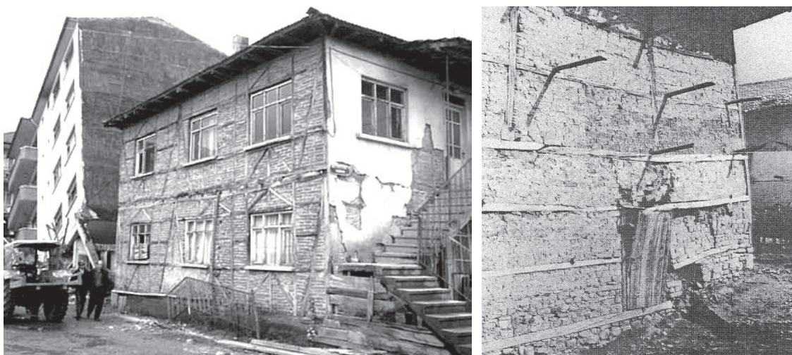
Fig.44 Architectures vernaculaires après des tremblements de terre : a) Habitation en ossature bois à côté d'un immeuble en ossature de béton armé renversé par le séisme de Kocaeli de 1999 (M 7.4), Turquie (Crédit : EEFIT) ; b) Bâtiment de deux étages en maçonnerie en briques de terre crue se situant exactement en correspondance de la rupture du terrain qui s'est produite à l'occasion du séisme de Gediz (Turquie) de 1970 (M 6.9), dont le déplacement vertical a été d'environ 50 cm (Crédit : Aytun).
