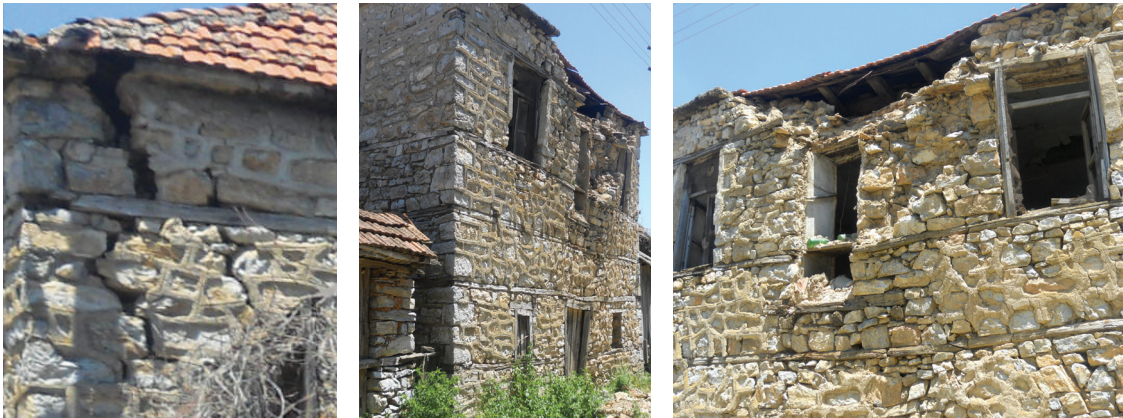
Fig.159 Fissuration verticale au sommet du bâtiment (a) avec successive inclinaison de la façade (b) et chute de pierres (c).
