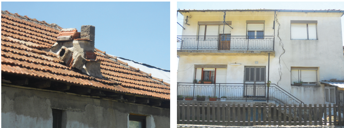
Fig.168 Autres types de dégâts : a) Effondrement de la cheminée ; b) Fissuration verticale entre le bâtiment original (à gauche) et la partie annexée (à droite).
