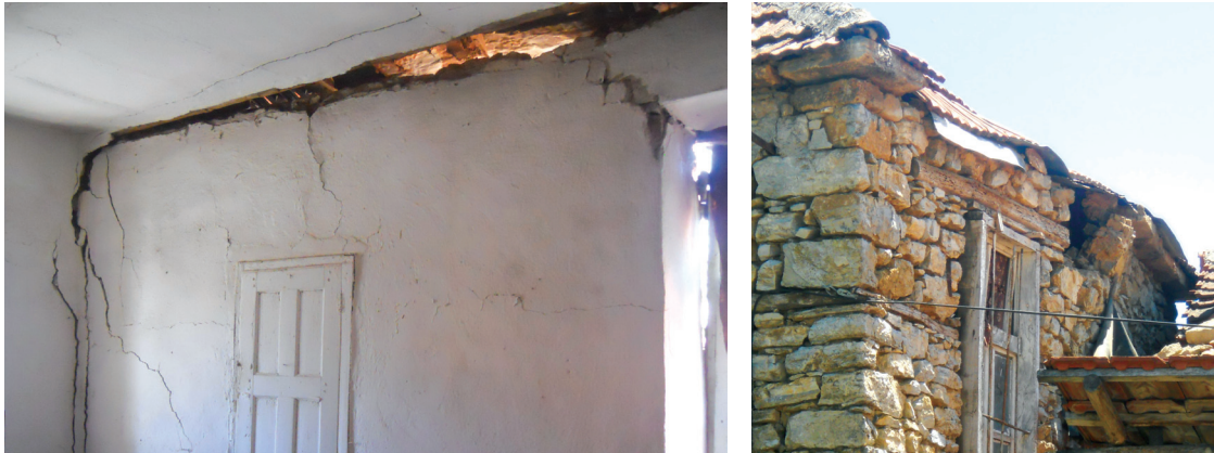
Fig.163 : Déconnexion entre le mur et la charpente : vues depuis l'intérieur (a) et l'extérieur (b) du même bâtiment.
