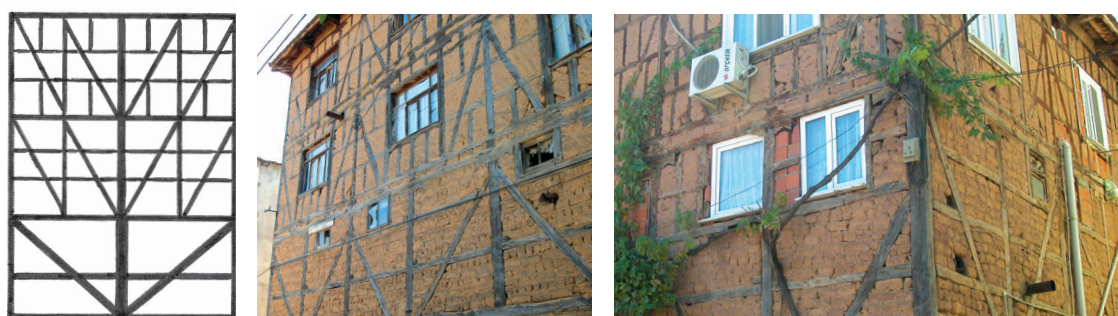
Fig.95 Variation du rapport bois/remplissage dans un même bâtiment ; a) Schéma : différences entre les parties inférieures et supérieures dans un segment vertical de l'ossature ; b) Réduction progressive de la dimension des panneaux de remplissage vers le haut (Ouest) ; c) Augmentation de la section des éléments de l'ossature vers le bas (Ouest).
