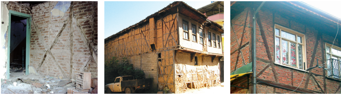
Fig.99 Contreventement : a) En forme de X dans les parois intérieures (Ouest) ; b) En forme de X dans les façades latérales aveugles et au rez-de-chaussée (Ouest) ; c) En forme de « Y renversé » à côté des ouvertures (Centre Est).
