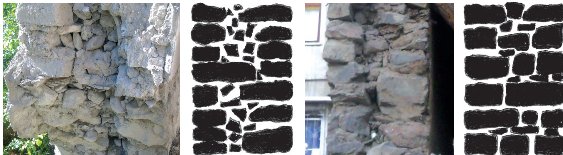
Fig.76 Maçonneries en moellons : a,b) Double mur avec blocage (Centre Ouest) et schéma en coupe ; c,d) Mur avec disposition homogène des pierres (Est) et schéma en coupe.
