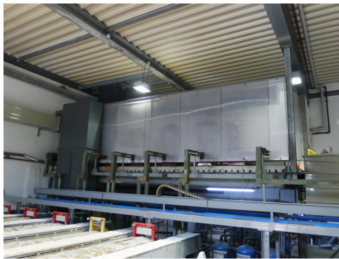
Figure 23 : Ventilation de la halle
