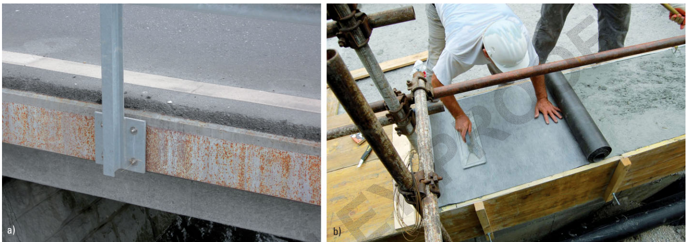
Bild 9 a) Rostpunkte auf einer in einer Stahlschalung hergestellten UHPFB Oberfläche, b) Bearbeitung der Oberflächen mit profilierter Folie [27] a) corrosion stains on a UHPFRC casted against a steel formwork, b) surface treatment of UHPFRC using a profiled membrane [27]
