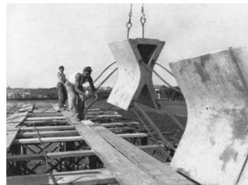
fig. 87 Église Nostra Signora della Misericordia (1957), Baranzate, A. Mangiarotti, B. Morassutti et A. Favini (ing.). Photo de chantier, installation des poutres précontraintes.
