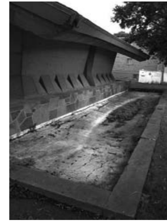
fig. 143 Église Saint-Rémi, Montréal. État actuel du bassin.
