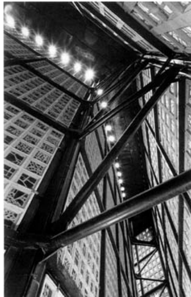
fig. 110 Église Kaiser-Wilhelm (1957-1961), Berlin, Egon Eiermann. Détail de l'espace technique où sont installés les projecteurs.
