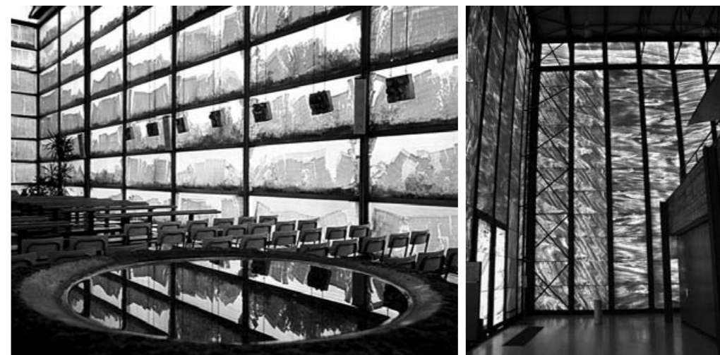
fig. 136 Nostra Signora della Misericordia, Baranzate. Vue intérieure des façades détériorées, 2002.
