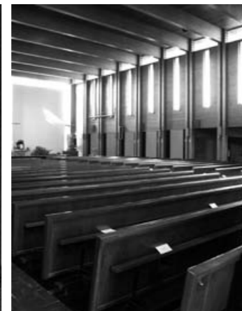
fig. 176 Saint-Maurice de Duvernay, Laval. Fentes sous la toiture, nef principale.
