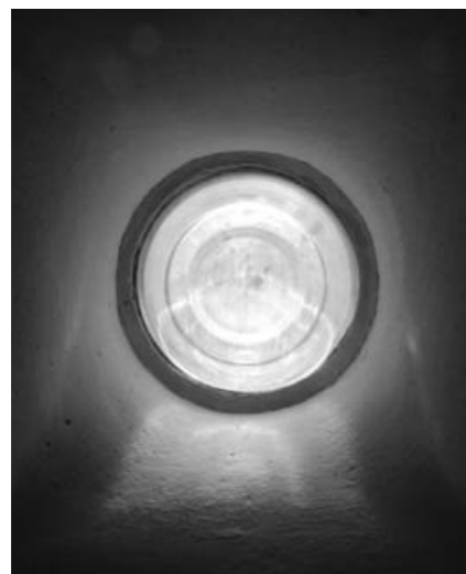
fig. 119 Église néo-apostolique de Genève. Détail d'un élément de verre inséré dans l'oculus du claustre.
