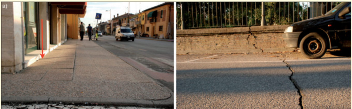
Bild 9. Geringfügige Gebäudesetzungen und Bodenrisse infolge Bodenverflüssigung entlang der Hauptstraße in Mirabello: Setzungen eines dreistöckigen Geschäftshauses mit Aufwölbung des Trottoirs (a), Riss durch eine Querstraße infolge seitlicher Bodenverschiebungen (b).
