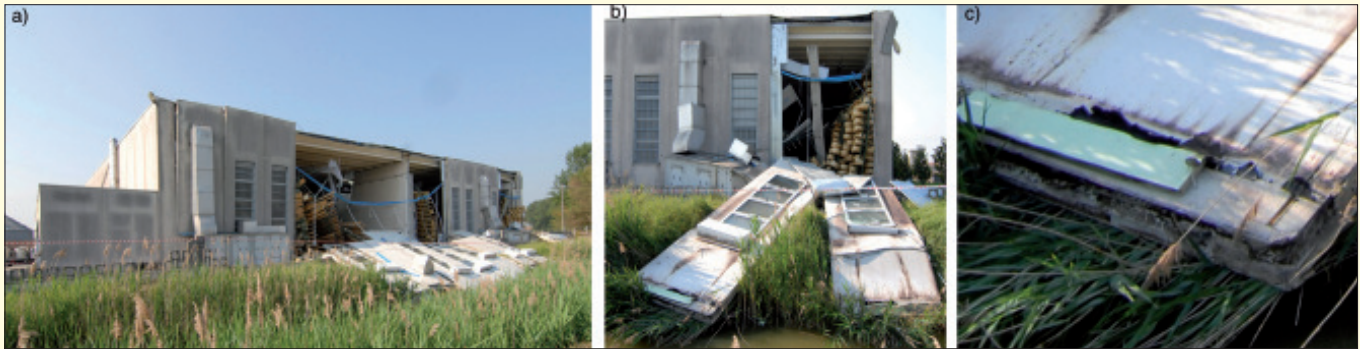
Bild 2. Lagerhalle für Parmesan mit umgekippten schweren Fassadenplatten in Moglia (a, b). Detailansicht (c) der Oberkante der linken Fassadenplatte in (b).
