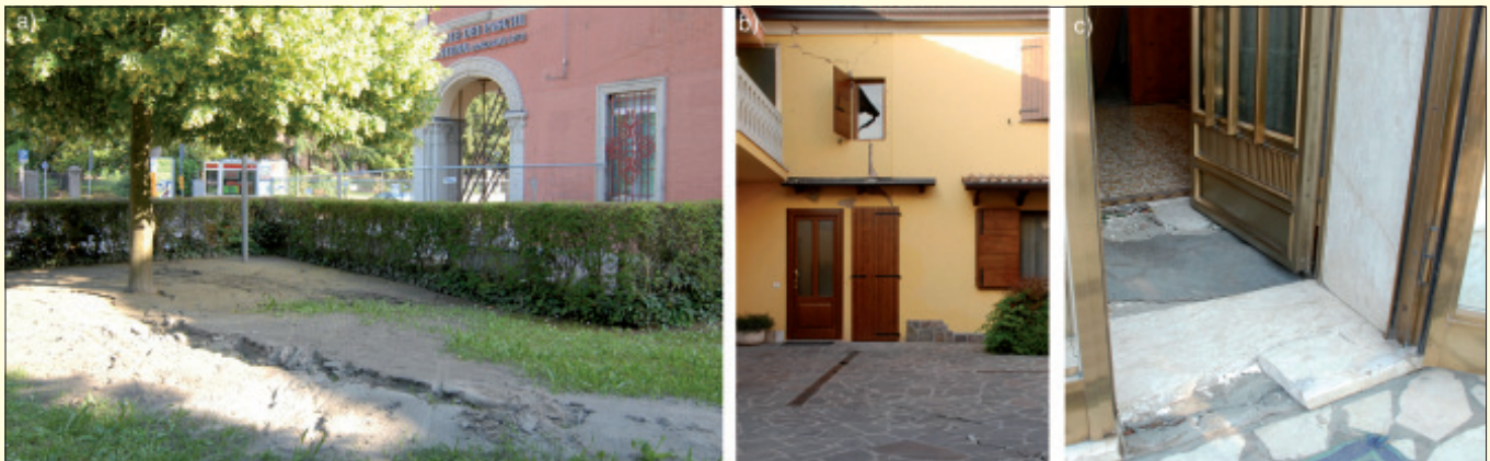
Bild 8. Bodenverflüssigung in Mirabello: Sandaustritt in einem Park (a), Trennris im Boden von der Bildecke rechts unten bis durch die Fassade im Hintergrund verlaufend (b), differentielle Setzungen zwischen Außenwand und Boden des Erdgeschosses im Eingangsbereich eines Wohnhauses (c).
