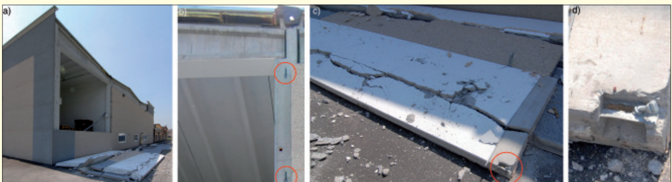
Bild 4. Lagerhalle mit umgekippten schweren Fassadenplatten in Cavezzo (a). In der mittleren Stahlbeton-Fertigteilstütze sind zwei Ankerschienen für Fassadenanker erkennbar (b). Ein daraus herausgerissener Fassadenanker ist im roten Kreis in (c) und im Detailfoto (d) ersichtlich.
