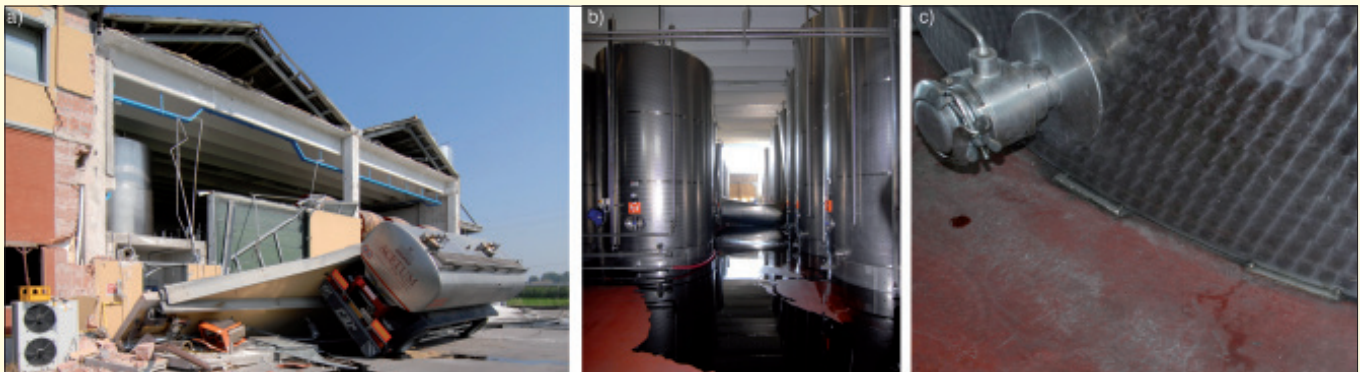
Bild 3. Essigfabrik mit umgekippten schweren Fassadenplatten in Motta (a). In der Halle kippte ein Stahltank mit Essig um und lief aus (b). Die Stahltanks sind am Boden unverankert (c).
