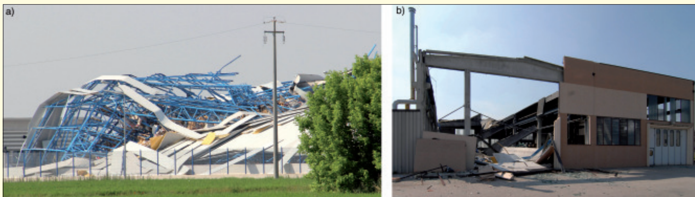
Bild 6. Eingestürzte Stahlhalle in Sant'Agostino (a) und eingestürzte Stahlbeton-Fertigteilhalle in Casumaro (b), in der als Folge des Erdbebens ein Brand ausgebrochen ist.
