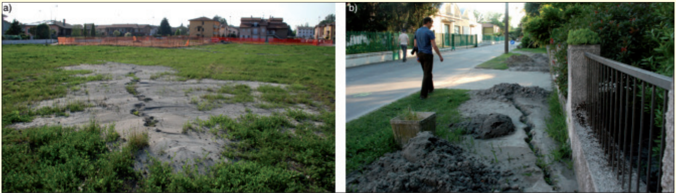
Bild 10. Sandaustritte durch Bodenrisse in San Carlo: in einem Feld (a), entlang der Viale Antonio Gramsci am Rande des abgesperrten Quartiers von San Carlo (b).
