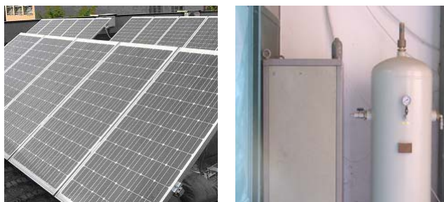
Fig. 13 Pannelli fotovoltaici e serbatoi di idrogeno
