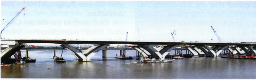
Bild 3. Bau der Woodrow Wilson Bridge (Foto 2006): unmotiviert gekrümmte, massive V-Elemente
