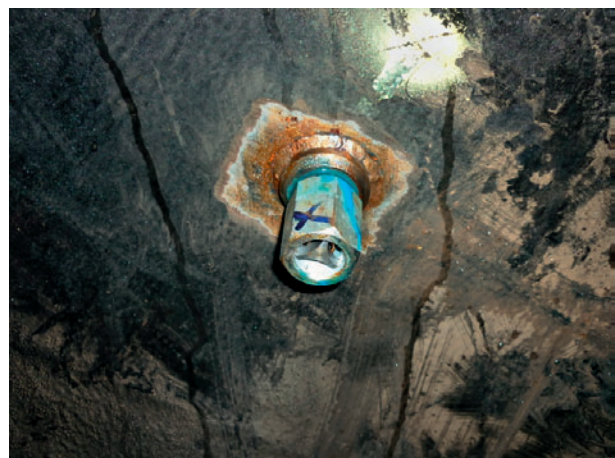
6 Einwegdruckentlastungsventil im Druckschacht Belleplace der Kraftwerke Emosson One-way relief valve in the Belleplace pressure shaft of the Emosson power plant (Quelle/Source: Soudant, March/März 2010)
