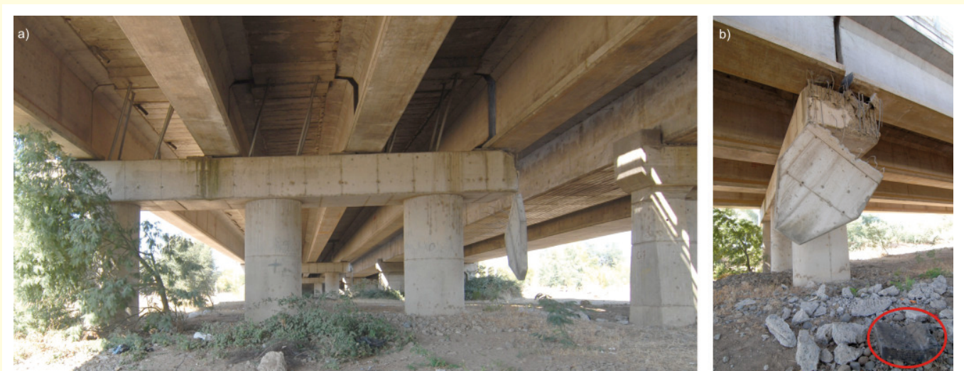
Bild 8. Querverschiebung der Autobahnbrücke „Puente Perquilauquéu“: Die Randträger rechts haben den seitlichen Puffer weggeschlagen und sind vom Gummilager auf das Stützenjoch gefallen (a). Ein Gummilager ist auf den Boden gefallen (b, rot umrahmt).
