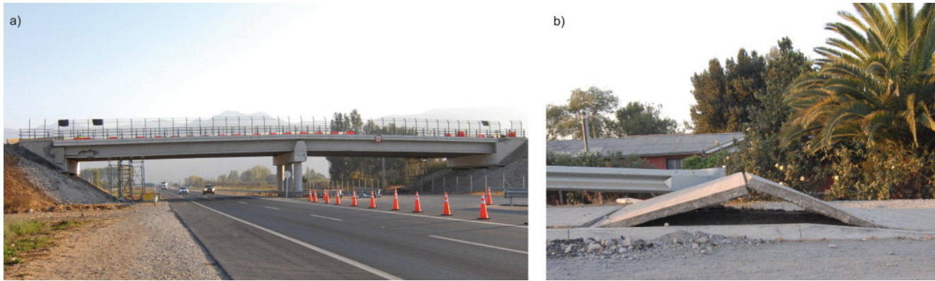
Bild 12. Überführung bei Chada mit schweren Schäden (a), Aufwölbung zweier Gehsteigplatten infolge starker Bodenbewegung direkt neben der Überführung (b).
