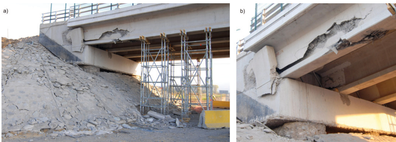
Bild 13. Widerlager der Überführung aus Bild 12. Der Randträger erlitt schwere Schäden im Unterflansch und im Steg beim Anprall an den seitlichen Puffer, der beschädigt stehen blieb (a). Die Träger sind quer von den Lagern gefallen und die Stangen der vertikalen Festhaltevorrückung stehen schräg (b).
