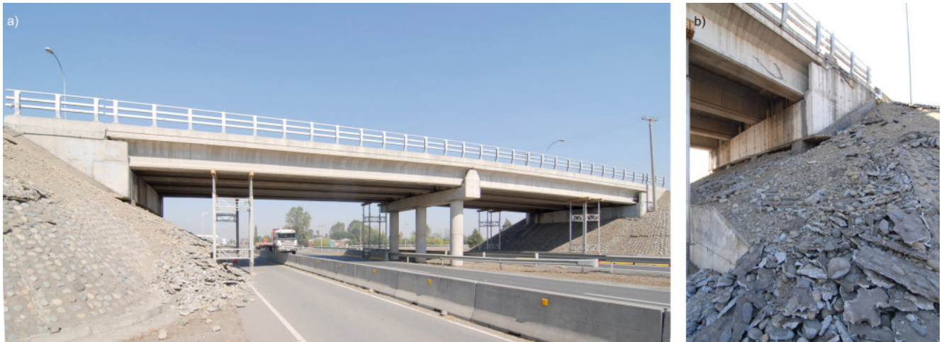
Bild 9. Überführung bei Talca mit kleineren Schäden (a). Setzungen des Strassendamms von ca. 50 cm (b) um das Widerlager links in Bild (a).
