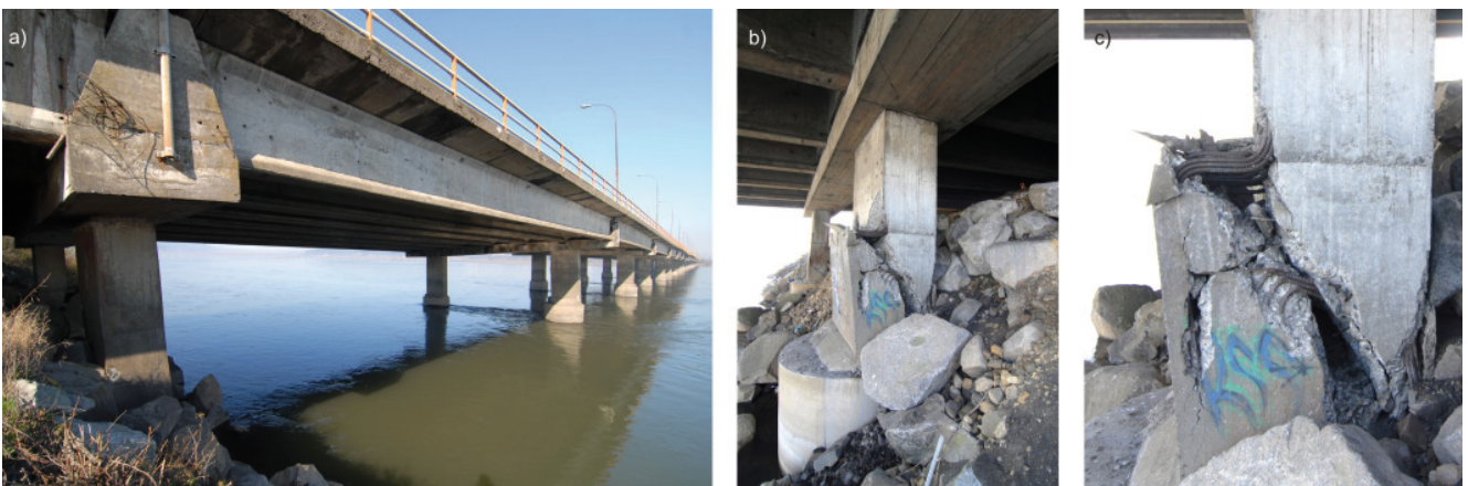
Bild 6. Stützenversagen bei der Brücke „Juan Pablo II“ über den Fluss Biobío in Concepción: Ansicht der Brücke mit den Stützen mit Schubbruch beim Ufer links (a), Detailansicht der Stütze mit Schubbruch (b und c).
