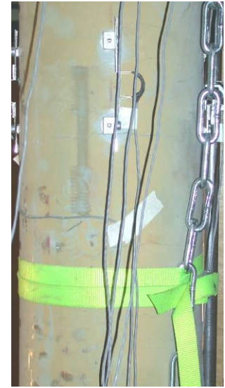
Abbildung 91: Zugrisse auf der Höhe des plastischen Gelenks
