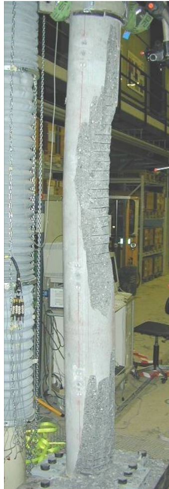
Abbildung 139: Grossflächige Abplatzungen auf der Druckseite. (Aufnahme aus südöstlicher Richtung)
