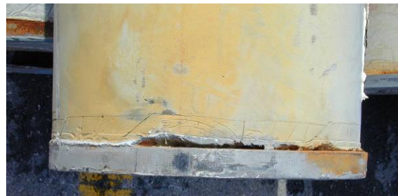
Abbildung 93: Hohlraum über der Endplatte am Stützenfuß
