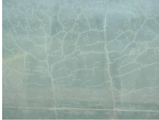
Abbildung 155: Schwindrisse auf der Oberfläche der bewehrten Stütze S3-8
