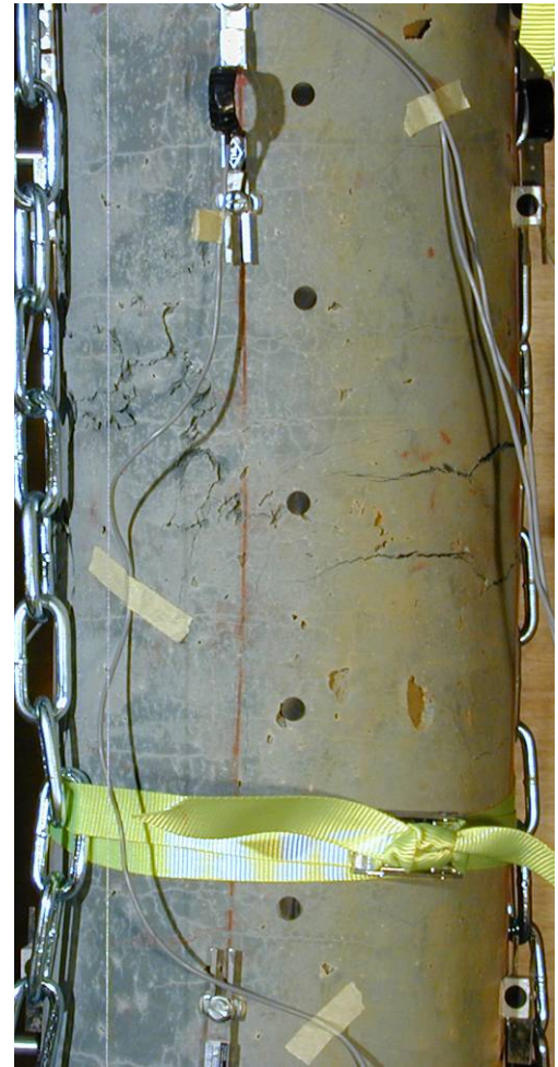
Abbildung 75: Plastisches Gelenk ungefähr 1.3 m über dem Stützenfuss
