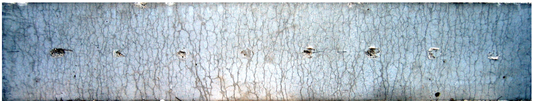
Bild 39: Rissbild des Versuchskörpers G18 nach Lagerung im Freien
