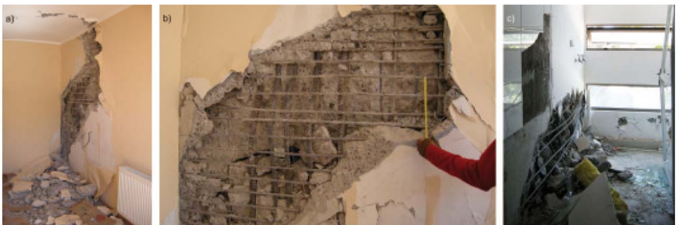
Bild 3. 24-stöckiges Stahlbetontragwandgebäude Castellon 152 in Concepción: Versagen der Stahlbetontragwände im ersten Obergeschoss.
