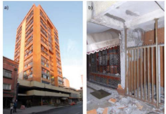
Bild 8. 17-stöckiges Stahlbetontragwandgebäude Torre Libertad in Concepción: Ansicht (a) und Biege-Druckversagen einer Wand im Erdgeschoss (b).
