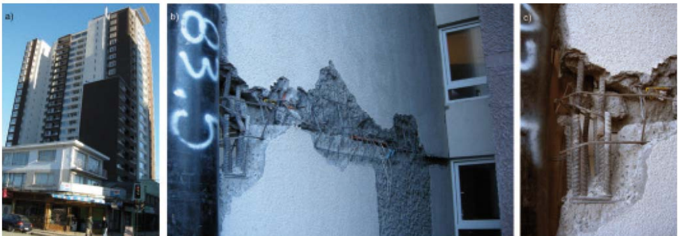
Bild 5. 21-stöckiges Stahlbetontragwandgebäude Salas 445 In Concepción: Ansicht (a) und Biege-Druckversagen einer Stahlbetontragwand im Erdgeschoss mit gerissener Endbewehrung (b und c).
