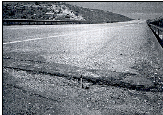
Figure 2.9: Photo d'un tassement local de la surface de roulement à l'extrémité d'un pont aux USA [Briaud et al. 1997]
