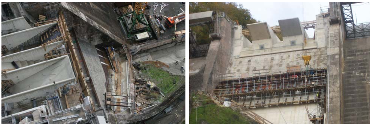
Figure 12: Construction du PK-Weir. Vue de dessus (à gauche) et vue d'aval (à droite)
