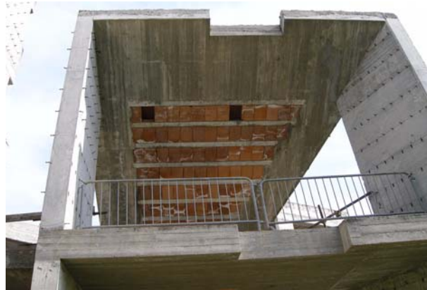
Bild 4.4: SLC-Deckensystem in einem praktisch unbeschädigten, nie in Betrieb genommenen Parkhaus im Rohbau in L'Aquila (KB0702)
