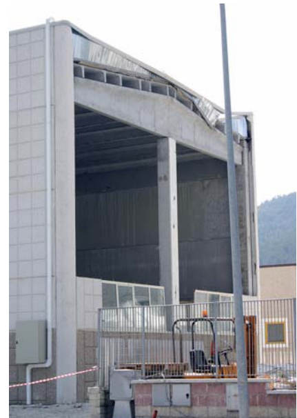
Bild 7.20: Herausfallen eines Grossteils der Fassade und Schäden am Dachaufbau eines Industriegebäudes im Stadtgebiet von L'Aquila nahe des Bahnhofs (AD0102)
