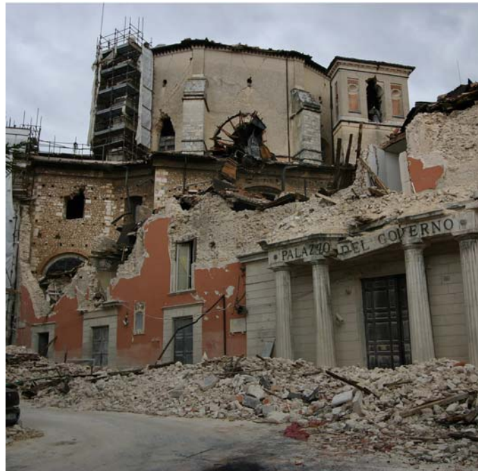
Bild 6.67: Totaleinsturz der Kuppel auf benachbartes Gebäudem. Mechanismus K9 (AD0565)
