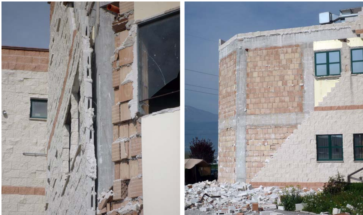
Bild 7.15: Ablösen und Herunterfallen der Fassadenverkleidung an einem Bürogebäude im Industriegebiet in Bazzano östlich von L'Aquila (FBR_P1000056 & FBR_P1000054)
