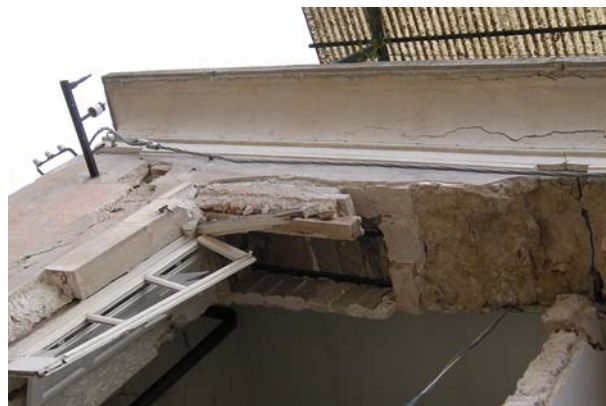
Bild 4.12: Gebäude im Bild 4.11: Zugbänder innerhalb von Mauersteinelementen auf Höhe der zweiten Geschossdecke (KB0687)
