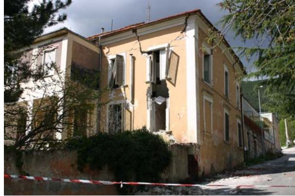
Bild 4.10: Schwer beschädigtes Wohnhaus aus Bruchsteinmauerwerk neben einem praktisch unbeschädigtem Gebäude aus Stahlbetonrahmen und Mauerwerksausfachung (AD0273)
