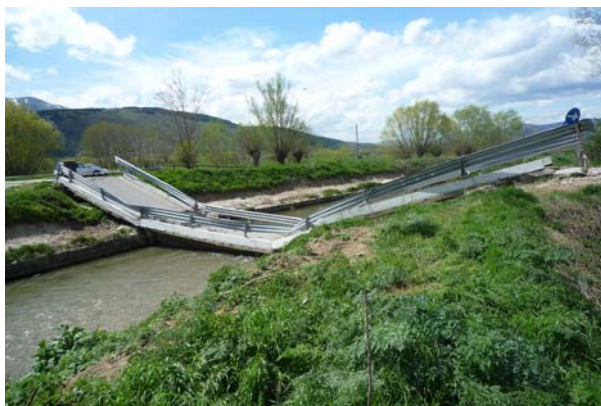
Bild 5.55: Kleine eingestürzte Brücke: Gesamtansicht (FBR_P1000164)
