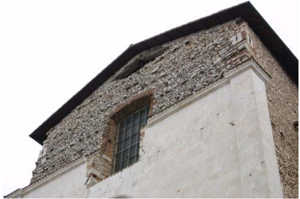
Bild 6.55: Herausbrechen des oberen Teils der Giebelwand gem. Mechanismus K2 (AD0424)
