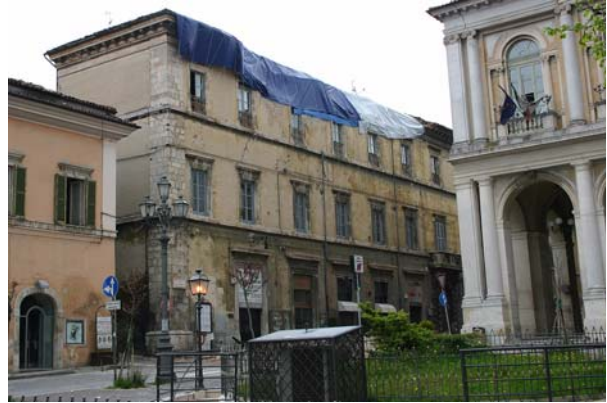
Bild 6.98: Schäden am Dach, die aufgrund der Abdeckung nicht definierbar sind (AD0448)
