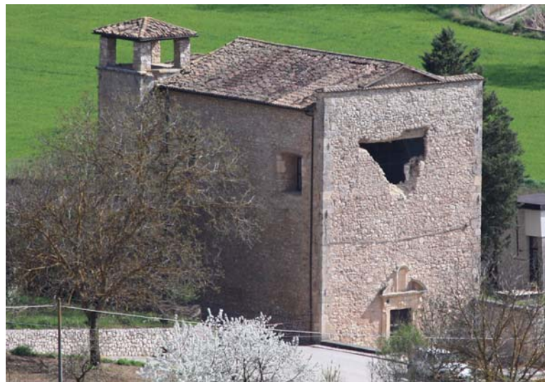
Bild 6.92: Herausbrechen eines Teils der Fassadenwand an einer Fensteröffnung gem. Mechanismus K3 (XMI_2555_1)
