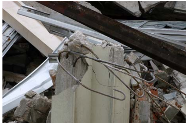
Bild 5.13: Hotel Duca degli Abruzzi: Stützenkopf mit glatten Bewehrungsstäben und fehlender Umschnürung (AD0488)
