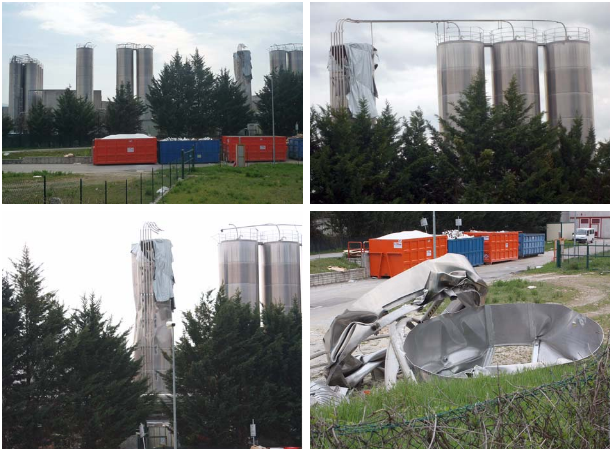
Bild 7.8: Mehrere Stehtanks auf einem Chemiefabrikgelände im Industriegebiet in Bazzano östlich von L'Aquila, die teilweise stark beschädigt oder eingestürzt sind (FBR_P1000087, FBR_P1000290, XMI_2469_1 und XMI_2609)
