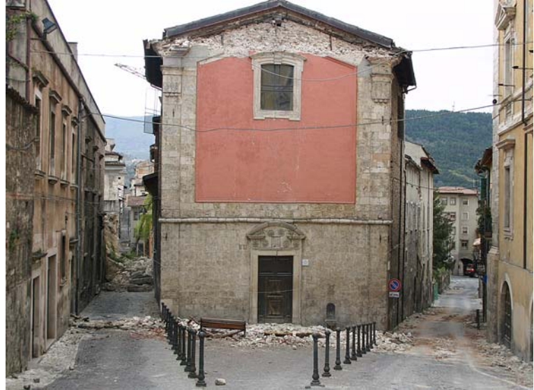
Bild 6.45: Ansicht an die Kirche mit Schäden nach dem Erdbeben. Auskippen des Giebelbereichs der (vorgemauerten) Fassade gem. Mechanismus K2 (AD0462)
