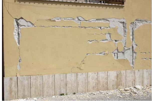
Bild 5.22: MFH 5: Schäden am Stahlbetonrahmenecke und an der Mauerwerksausfachung (AD0247)
