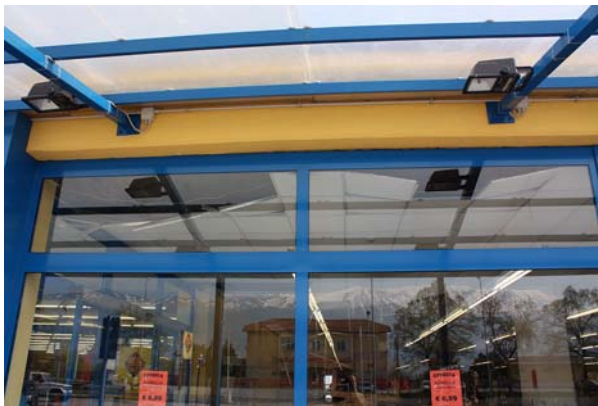
Bild 7.22: Teilweises Abreißen der abgehängten Deckenkonstruktion in einem Supermarkt im Industriegebiet Bazzano östlich von L'Aquila (XMI_2462_1)
