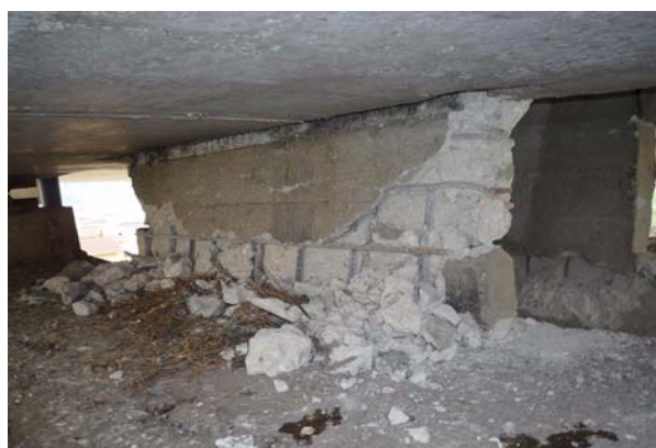
Bild 5.76: Viadotto San Sisto: Versagte Schubnocke (KB_P342)
