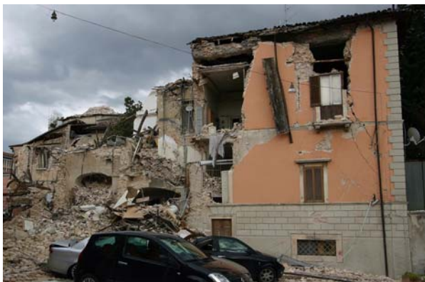
Bild 4.19: Gebäude bei dem trotz Ringbalken ein Versagen aus der Ebene aufgetreten ist (AD0558)
