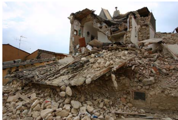
Bild 4.6: SLC-Deckensystem in einem eingestürzten Bruchsteinmauerwerksgebäude in Onna (AD0016)
