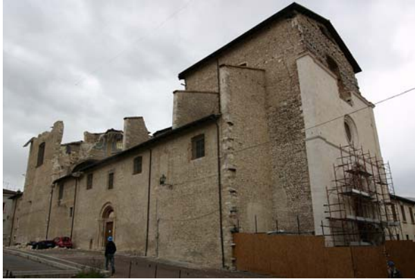
Bild 6.54: Ansicht an die eingeriüstete Hauptfassade mit lokalen Schäden (AD0422)
