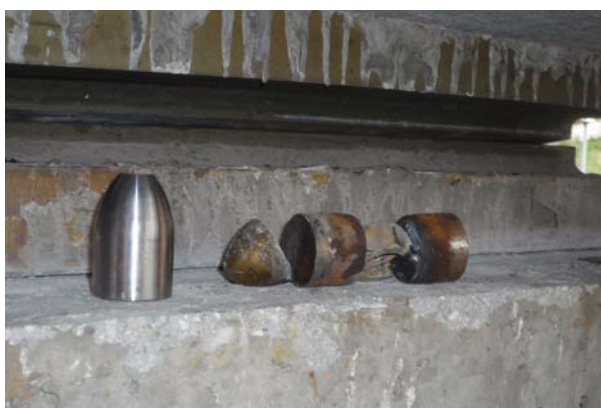
Bild 5.75: Viadotto San Sisto: Zapfen, neu und versagter alter, der das Verschieben des Kipplagers in Brückenquerrichtung verhindern soll (KB_P346)
