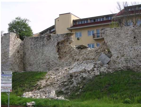
Bild 7.9: Teilweise eingestürzte alte Stadtmauer in der Nähe des Bahnhofs von L'Aquila (AD0070)
