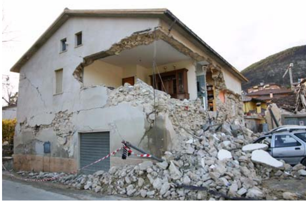
Bild 4.21: Wohnhaus aus Bruchsteinmauerwerk bei dem trotz Ringbalken und steifen Decken Versagen aus der Ebene aufgetreten ist (AD0341)
