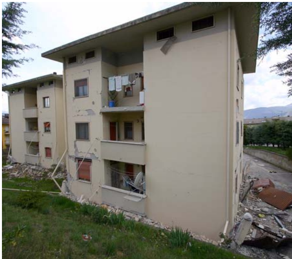
Bild 7.13: Herausgefallene oberste Balkonbrüstung an einem Wohngebäude im Stadtgebiet von L'Aquila nördlich vom Krankenhaus San Salvatore (AD0243)
