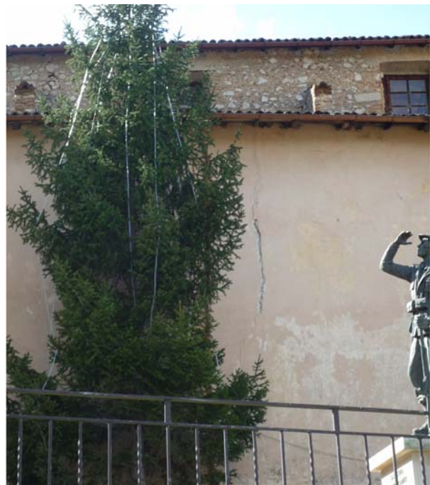
Bild 6.75: Gross Risse in der Aussenwand gem. Mechanismus K13 (FBR_P1000197)
