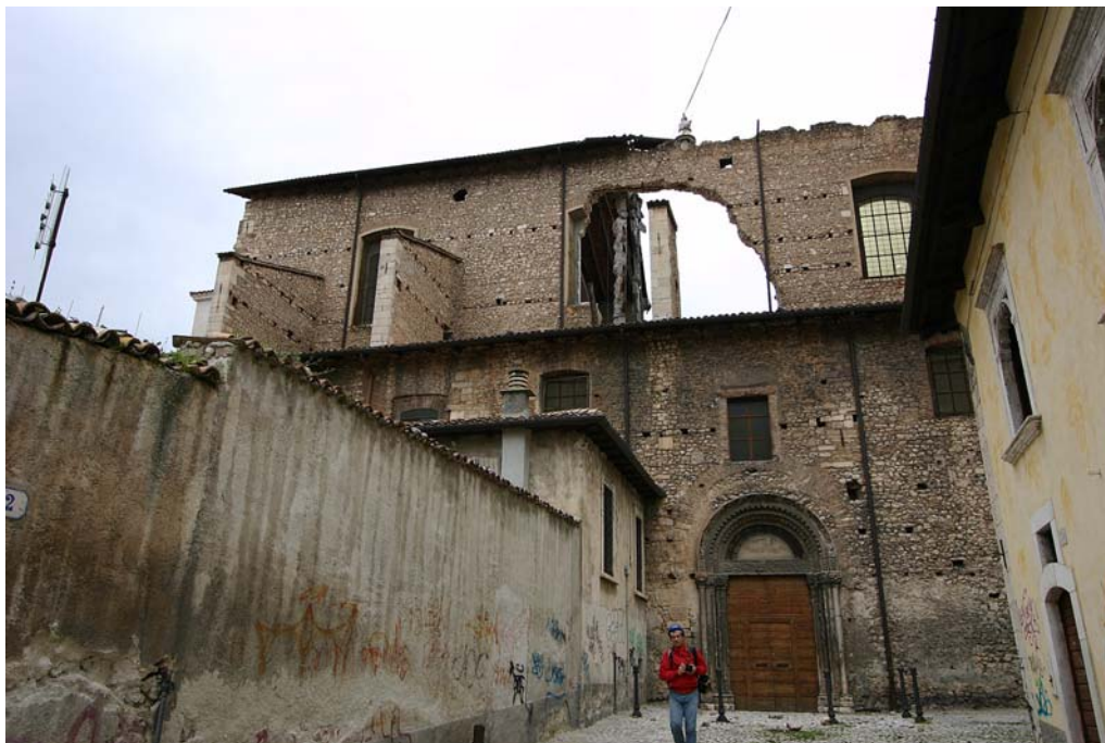
Bild 6.58: Herausbrechen eines Teils der oberen Seitenwand gem. Mechanismus K10 (AD0433)
