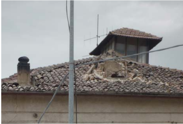
Bild 7.3: Eingestürzter Schornstein eines Wohnhauses in der Via Vasca Penta im östlichen Stadtgebiet von L'Aquila (FBR_P1000126)
