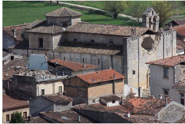
Bild 6.90: Auskippen der Giebelwand und Herausfallen der Rosette in der Fassade, sichtbare grosse Risse in Fassadenfläche und Schäden am Glockenturm gem. Mechanismen K2, K3 und K18 (XMI_2557_1)
