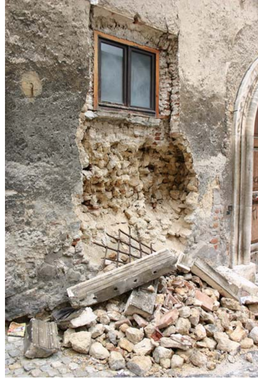
Bild 6.102: Heruntergefallenes Fenstergitter nach Versagen des Fusses der Fassadenvormauerung gem. Mechanismus P6 (AD0437)
