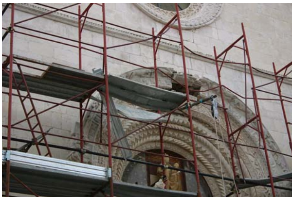
Bild 6.56: Lokale Schäden an der Bogenstruktur der Öffnung mit Rissen in der Fassadenfläche gem. Mechanismus K3 (AD0426)
