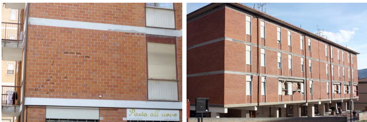
Bild 7.16: Grosse sichtbare Risse oder Herausfallen der Klinkerfassade an Wohngebäuden im Stadtgebiet von L'Aquila (FBR_P1000106 & XMI_2573_1)
