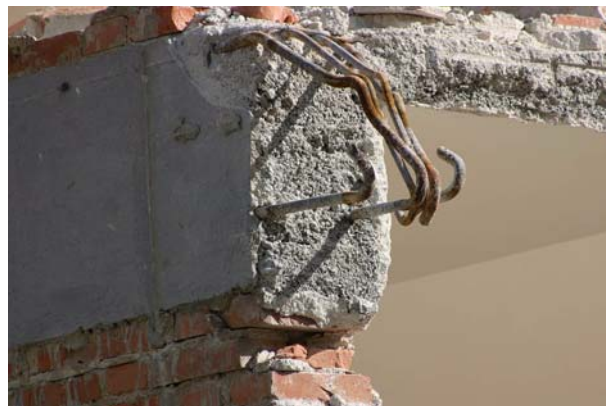
Bild 5.4: Zweigeschossiges Stahlbetonrahmengebäude: Glatter Bewehrungsstahl und fehlende Bügel (AD0315)
