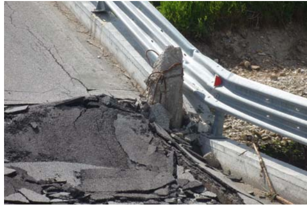
Bild 5.60: Kleine eingestürzte Brücke: Durchstanzen der Stützen durch die Fahrbahnplatte (FBR_P1000167)
