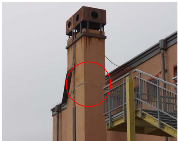
Bild 7.6: Grosse sichtbare Risse am Kamin der Scuola Secondaria "Dante Alighieri" in der Via Acquasanta im östlichen Stadtgebiet von L'Aquila (XMI_2504_1)
