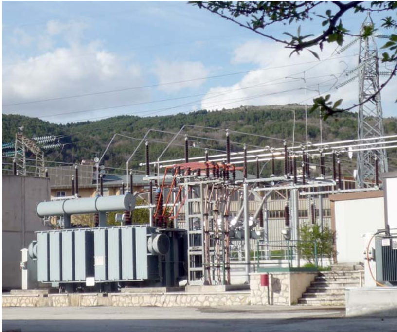
Bild 7.26: Unterwerk im nordöstlichen Stadtgebiet von L'Aquila (FBR_10000218)
