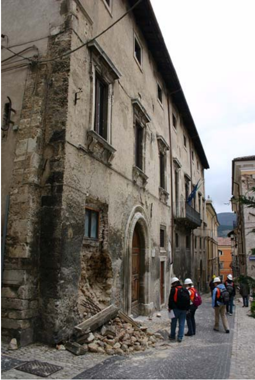
Bild 6.101: Lokaler Schaden am Fenster im Erdgeschoss (AD0436)
