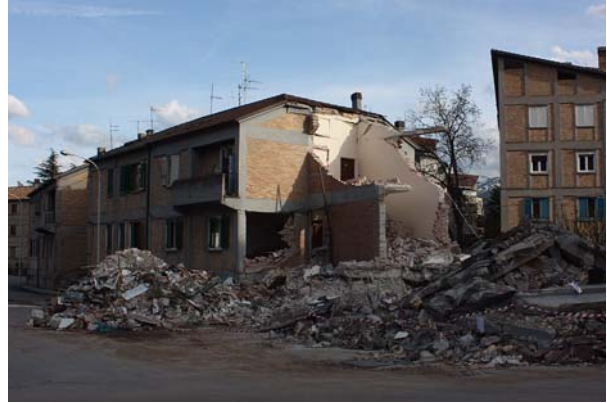
Bild 5.2: Zweigeschossiges Stahlbetonrahmengebäude: Nach dem Erdbeben (XMI_2574)
