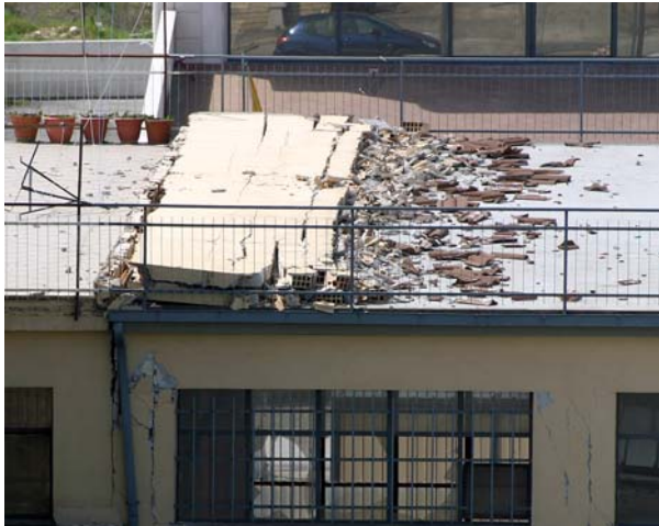
Bild 7.11: Umgekippte moderne freistehende Mauer auf einem Hausdach im Stadtgebiet von L'Aquila westlich des Bahnhofs (AD0091)
