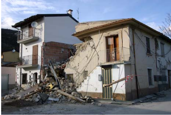
Bild 4.9: Eingestürztes Wohnhaus aus Bruchsteinmauerwerk neben einem zwar beschädigten, aber stehengebliebenem Wohnhaus aus Betonsteinen (AD0342)
