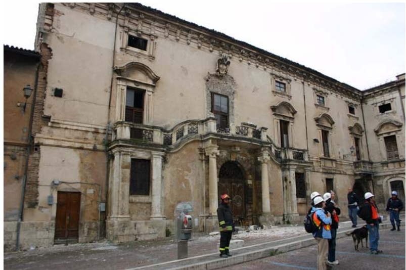
Bild 6.100: Heruntergefallen der Fensterverkleidungen und der Balkonbrüstung gem. Mechanismus P18 (AD0414)
