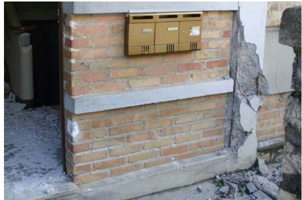
Bild 5.10: Dreigeschossiges Stahlbetonrahmengebäude: Nahaufnahme der kurzen Stütze neben dem Hauseingang (AD0324)
