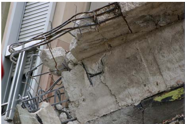
Bild 5.14: Hotel Duca degli Abruzzi: Riegel mit glatten Bewehrungsstäben und ungenügender Schubbewehrung und mangelhafter Ausführung des Knotenbereichs (AD0490)
