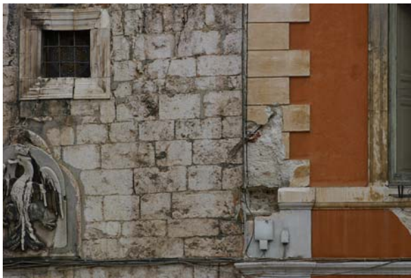
Bild 6.95: Abplatzungen an der Gebäudefuge zum Turm infolge "pounding" (AD0446)
