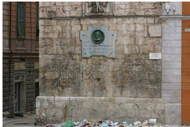
Bild 6.96: Sichtbare Risse am Turmfuss möglicherweise infolge des Bebens gem. Mechanismus K16 (AD0447)
