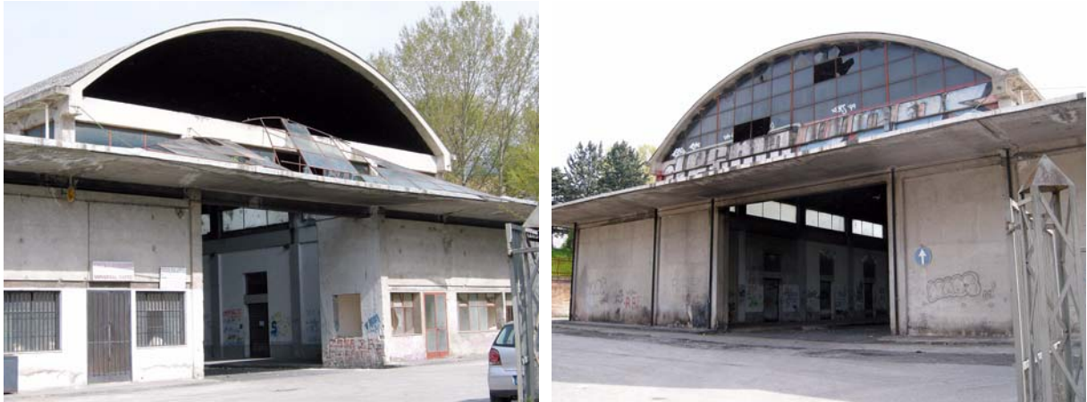
Bild 7.21: Herausgefallene (KB0716) und leicht beschädigte (KB0717) Glasfassade bei einer Obst- und Gemüsemarkthalle in der Via Pile, westlich vom Bahnhof L'Aquila
