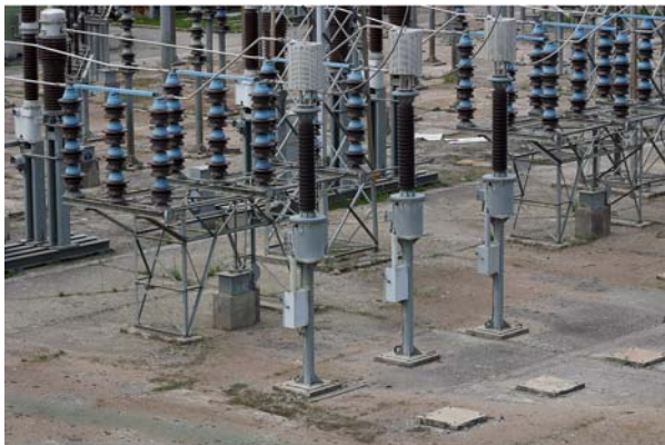
Bild 7.24: Unterwerk im nordwestlichen Stadtgebiet von L'Aquila (AD0118)
