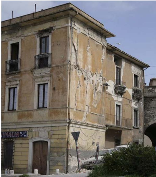
Bild 3.5: Schäden an einem Gebäude von L'Aquila aus Bruchsteinmauerwerk mit Erdgeschoss aus behauenen Natursteinblöcken (Web)
