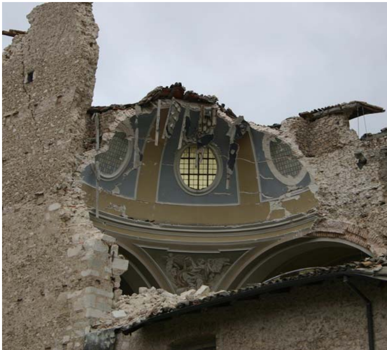
Bild 6.52: Teileinsturz der Kuppel gem. Mechanismus K9 (AD0412)
