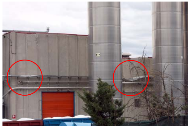
Bild 7.23: Schäden an den Ausseninstallationen eines Industriegebäudes in Bazzano östlich von L'Aquila (XMI_2616)
