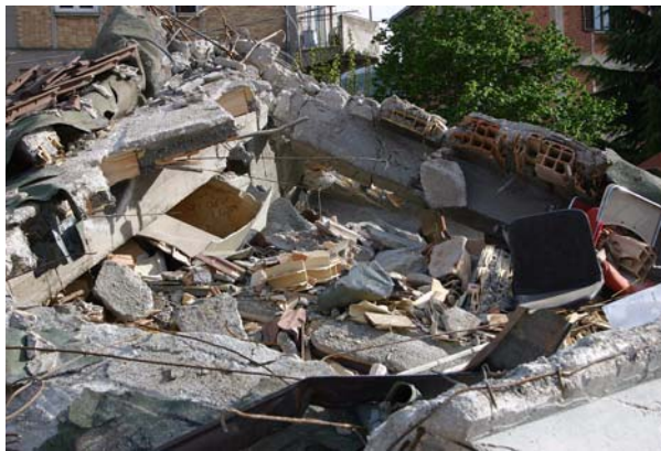
Bild 4.5: SLC-Deckensystem in einem eingestürzten Stahlbetonrahmengebäude in L'Aquila (AD0317)
