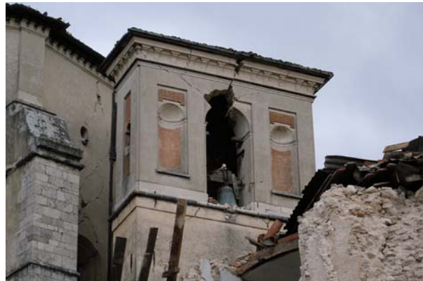
Bild 6.69: Schäden an triumphbogen-ähnlichem Gebäudeteil gem. Mechanismus K8 (AD0927)
