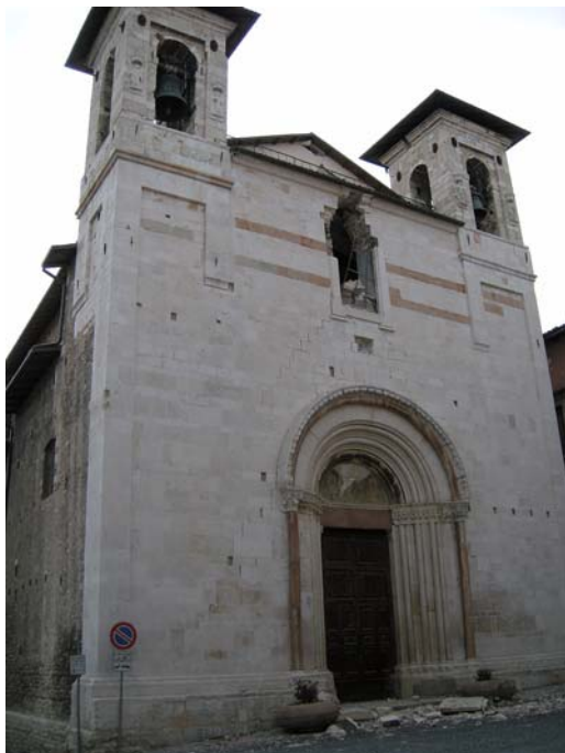
Bild 6.62: Ansicht an die mit grossen Rissen durchzogene Hauptfassadenwand gem. Mechanismus K3 (AD0924)
