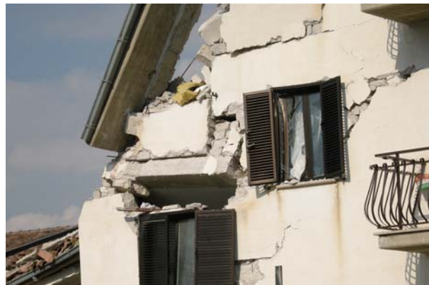
Bild 4.26: Nahaufnahme der versagten Gebäudeecke (KB0663)
