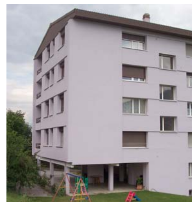
Bild 3.30: Wohnbau in einem Walliser Dorf mit soft-storey Gefährdung (XMI)
