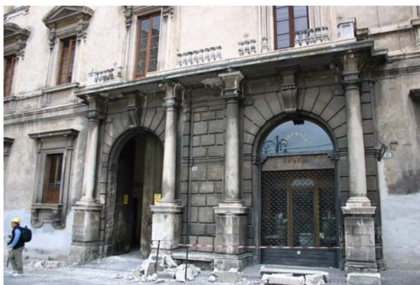
Bild 6.103: Palast 1: Heruntergefallene schwere Balkonbrüstung gem. Mechanismus P18 (AD0451)
