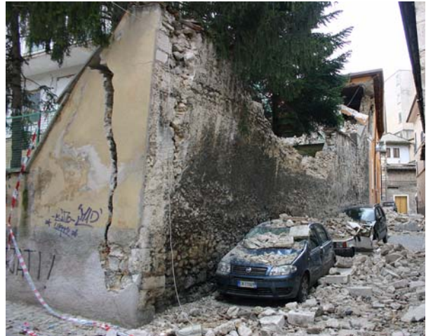
Bild 7.12: Stark beschädigte und teilweise eingestürzte alte Mauer in der Via Antonelli im historischen Zentrum von L'Aquila (AD0470)
