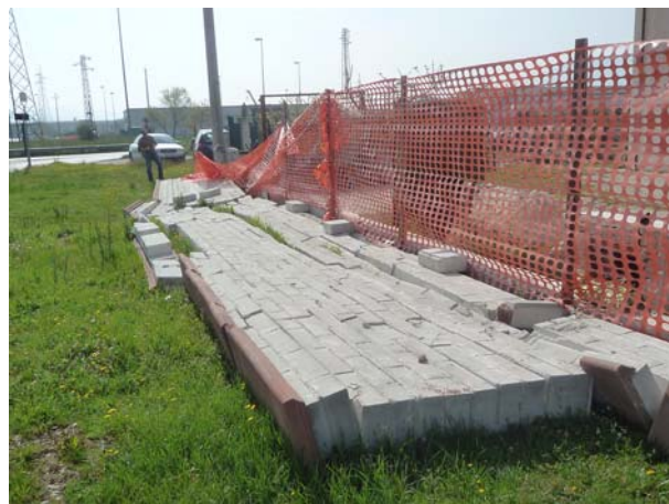
Bild 7.10: Umgestürzte moderne Mauer im Industriegebiet in Bazzano östlich von L'Aquila (FBR_P1000067)
