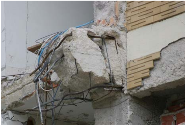
Bild 5.18: Studentenwohnheim: Versagtes Anschlussdetail (AD0530)
