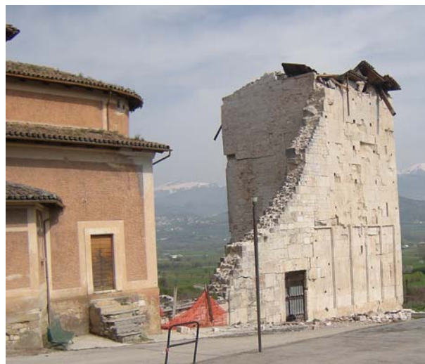
Bild 6.78: Einsturz des Turmaufbaus der antiken Kathedrale gem. Mechanismus K16 und heraus gefallene Steine in der Fassadenwand gem. Mechanismus K3 (SFR_1924)
