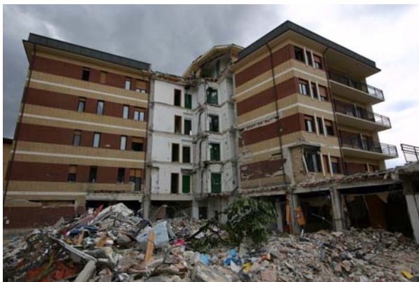
Bild 5.16: Studentenwohnheim: Ein angebauter Teil ist eingestürzt (AD0528)
