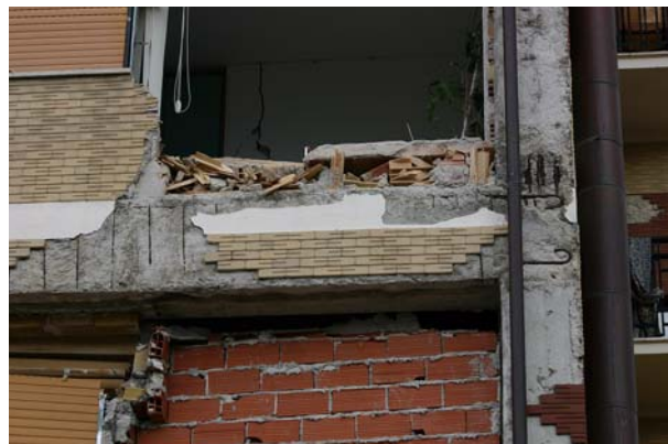
Bild 5.17: Studentenwohnheim: Detail eines nicht eingestürzten Gebäudeteils (AD0526)
