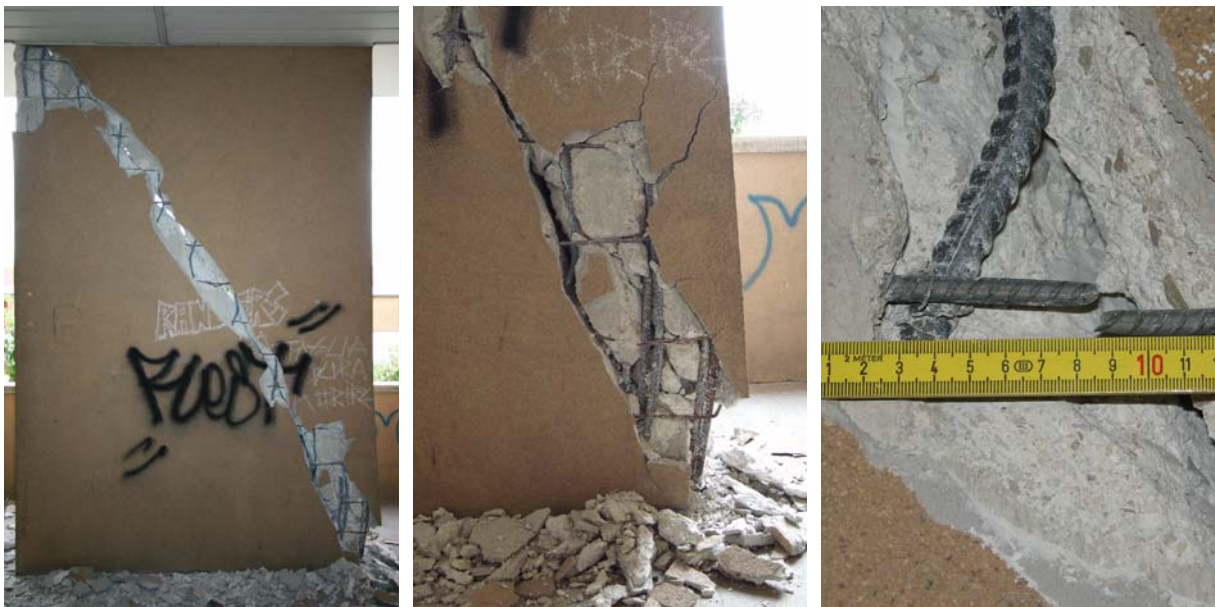
Bild 5.52: MFH 1 mit Stahlbetonwänden: Rechteckige Wand am Westende des Gebäudes (AD0185, KB0777, KB0776)
