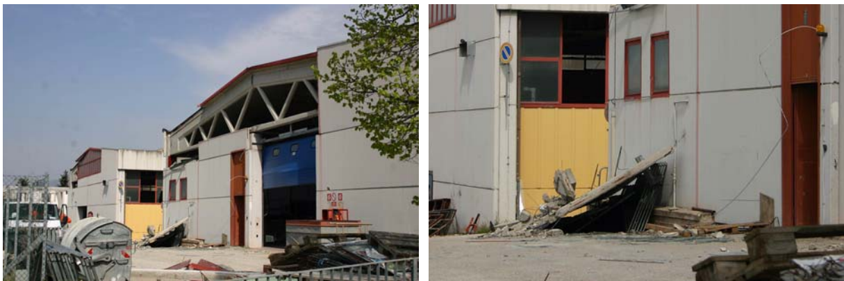
Bild 5.82: Lagerhalle aus vorfabrizierten Stahlbetonteilen mit teilweise heruntergefallenen Fassadenelementen (AD0080, AD0075)
