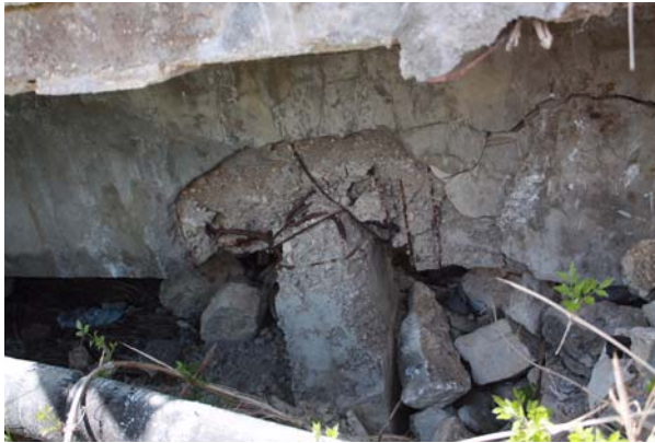
Bild 5.59: Kleine eingestürzte Brücke: Versagtes Stützenauflager (XMI_2530)
