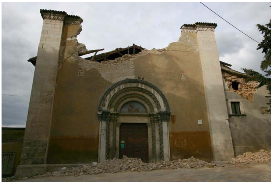
Bild 6.46: Ansicht an die Kirche mit Schäden nach dem Erdbeben. Herausbrechen grosser Teile der oberen Fassadenfläche gemäss Mechanismus K2 (AD0554)
