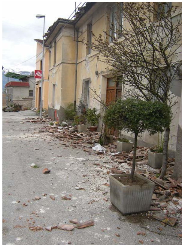
Bild 7.2: Heruntergefallene Dachziegel an einem Wohngebäude in Paganica (SFR_2036)
