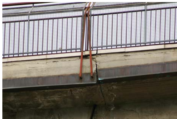
Bild 5.64: Stadtbrücke: Fahrbahnplatte oberhalb des Auflagers des eingehängten mittleren einfachen Balkens (AD0520)
