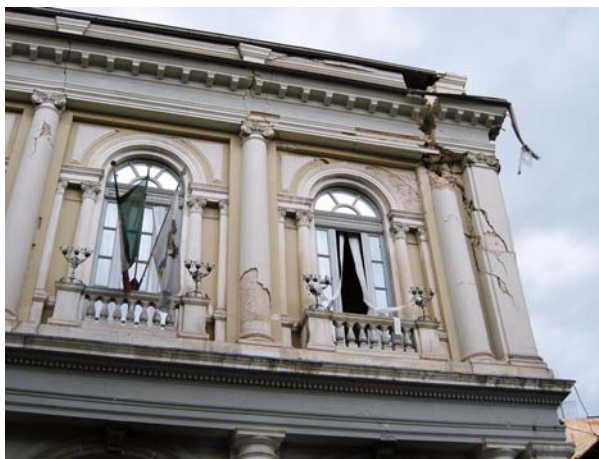
Bild 4.7: Wohnpalast im Stadtzentrum von L'Aquila mit Versagensmechanismus aus der Ebene (AD0944)
