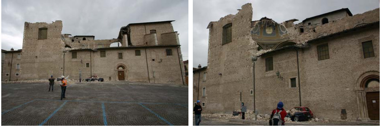
Bild 6.50: Einsturz grosser Teile des mittleren Dachs gem. Mechanismus K4 und der Kuppel gem. Mechanismus K9 (AD0409, AD0411)
