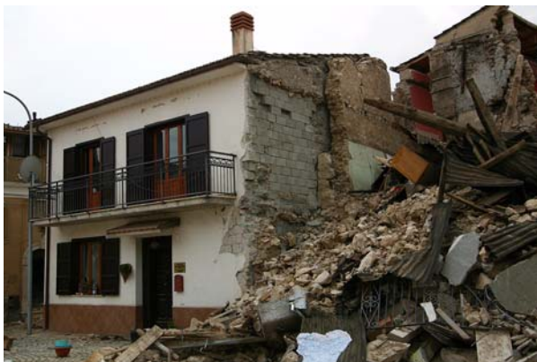
Bild 4.27: Wohngebäude in Onna aus Betonsteinmauerwerk (AD0025)
