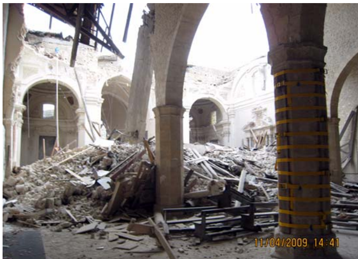
Bild 3.1: Eingestürzte Decke der Kirche Santa Maria di Collemaggio in L'Aquila (Web)
