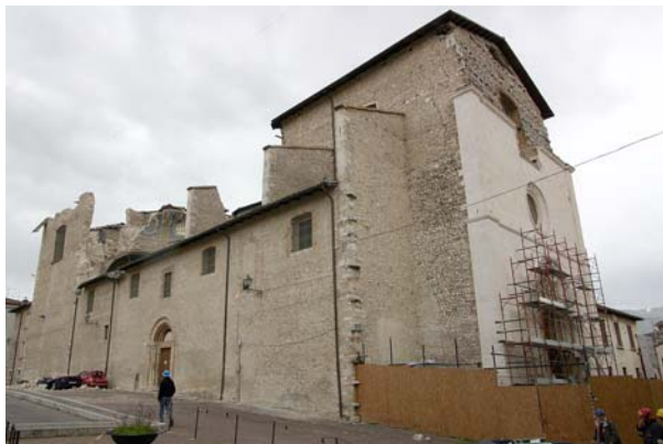
Bild 3.33: Kirche Santa Maria Paganica im Stadtzentrum von L'Aquila (AD0422)
