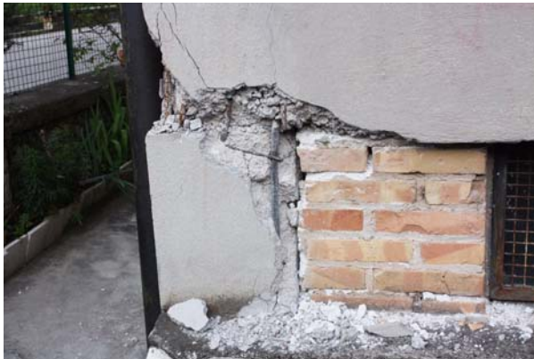
Bild 5.9: Dreigeschossiges Stahlbetonrahmengebäude: Nahaufnahme der kurzen Stütze an der Gebäudeecke (XMI_2575)
