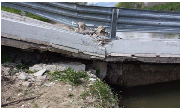
Bild 5.57: Kleine eingestürzte Brücke: Versagtes Stützenaullager am Flussbett (XMI_2536)
