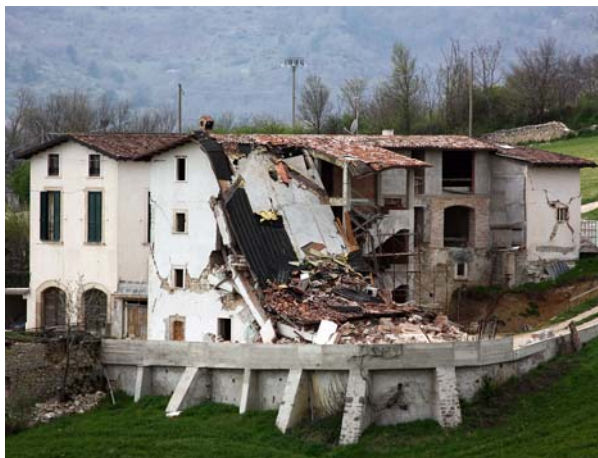
Bild 3.3: Schäden an einem Mauerwerksgebäude östlich der Stadt L'Aquila (XMI_2483_1)
