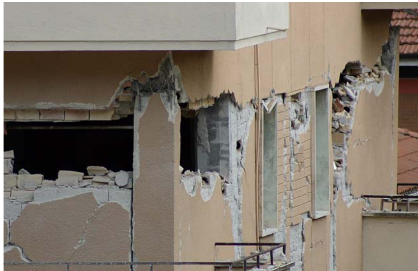
Bild 5.36: Stahlbetonrahmengebäude im Stadtzentrum: Nahaufnahme der beschädigten Stützen und Knoten im 1. OG (AD0561)
