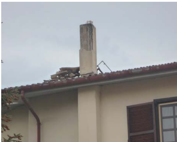
Bild 7.5: Schornstein mit abgeplatzt Putz an einem Wohnhaus in der Strada Vicinale dei Cappuccini im östlichen Stadtgebiet von L'Aquila (FBR_P1000131)
