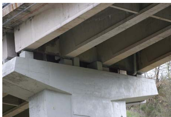
Bild 5.66: Autobahnbrücke nahe des Epizentrums: Auflager der als einfach Balken ausgeführten Brückenträger (AD0165)
