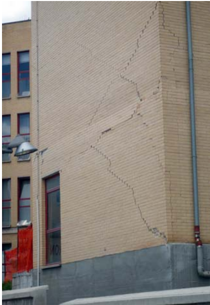
Bild 7.17: Typische kreuzförmige Rissentwicklung bei Erdbebenbeanspruchung in Klinkerfassade in einer Gebäudeaussenwand des Ospedale San Salvatore in Coppito (FBR_P1000145)
