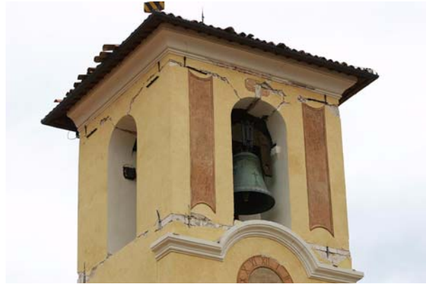
Bild 4.14: Glockenturm mit Zugstangen im Stadtzentrum von L'Aquila (AD0483)
