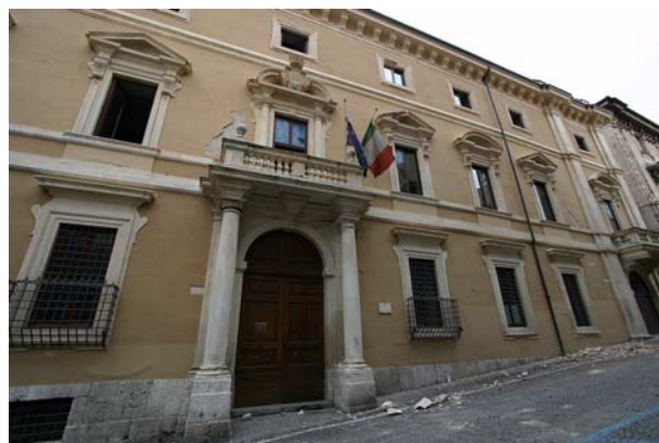
Bild 6.104: Palast 2: Bedeutende Schäden an den Aussenwänden aus Bruchsteinmauerwerk gem. Mechanismen P5 und P6 (AD0455)
