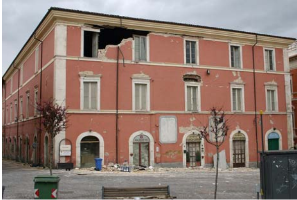
Bild 6.97: Versagen im oberen Bereich der Fassadenaussenwand gem. Mechanismus P3 (AD0443)
