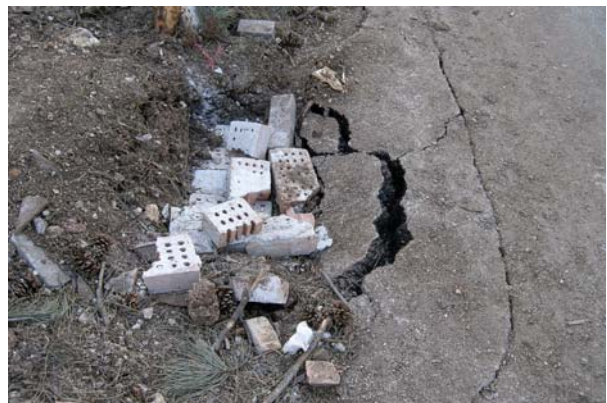
Bild 5.6: Strassenschaden neben dem zweigeschossigen Stahlbetonrahmengebäude (KB0862)
