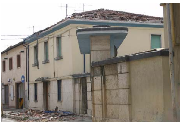
Bild 7.1: Einsacken des Daches des Bahnhofsgebäudes von Bazzano (SFR_1921) und eines Wohnhauses in der Via Pile vom Bahnhof L'Aquila (AD0065)
