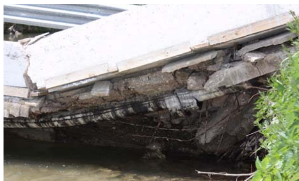
Bild 5.58: Kleine eingestürzte Brücke: Versagter Brückenträger (XMI_2547)
