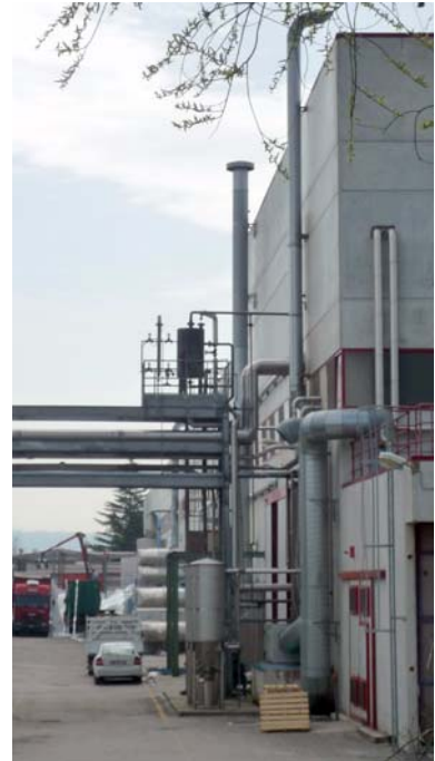
Bild 7.27: Leitungen mit Befestigung am Gebäude und Durchdringung der Gebäudehülle im Industriegebiet in Bazzano östlich von L'Aquila (FBR_1000091)
