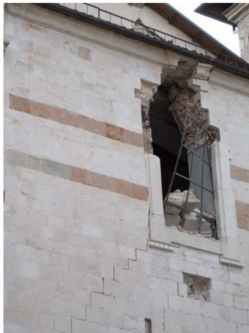
Bild 6.63: Lokale Ausbrüche an den Öffnungen innerhalb der Fassadenfläche gem. Mechanismus K3 (AD0925)
