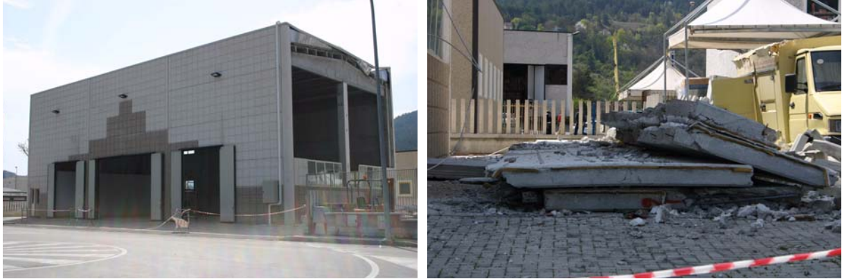
Bild 5.83: Fabrikhalle aus vorgefertigten Stahlbetonteilen, bei der an der an einer Stirnseite die Fassadenelemente heruntergefallen sind (AD0101, AD0103)
