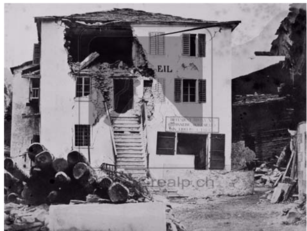
Bild 3.4: Schäden an einem Mauerwerksgebäude von Visp infolge des Erdbebens von 1855 (CREALP)
