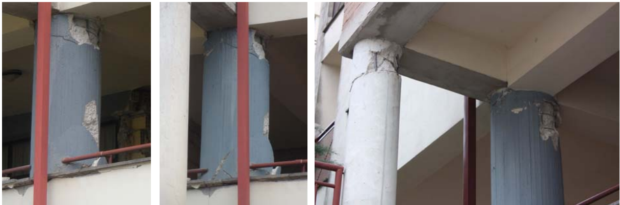
Bild 5.41: MFH mit weichem Erdgeschoss: Nahaufnahmen der kurzen Stützen im Erdgeschoss (SFR_2026, FBR_P1000272, XMI_2594)
