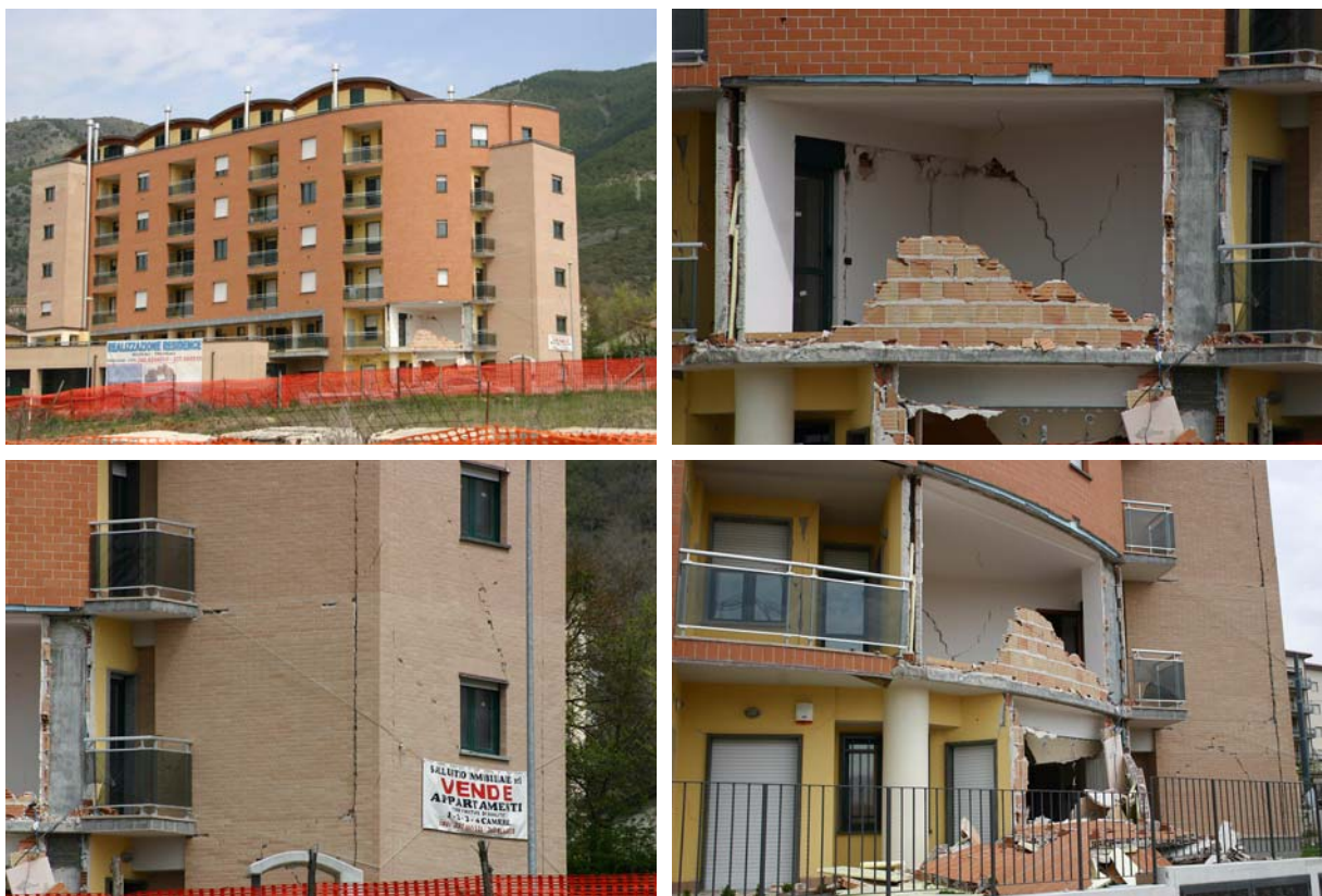
Bild 5.45: Neu gebautes, noch unbezogenes Wohngebäude mit starken Schäden an den Mauerwerksausfachungen und der Klinkerfassade (AD0113, AD0114, AD0116, AD0152)
