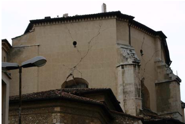
Bild 6.68: Grosse Risse in Aussenwänden unterhalb der Kuppel gem. Mechanismus K13 (AD0562)
