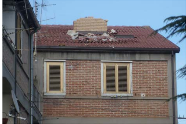
Bild 7.4: Teilweise eingestürzter Schornstein eines Mehrfamilienhauses im nördlichen Stadtgebiet von L'Aquila beim Viadotto San Sisto (FBR_P1000233)
