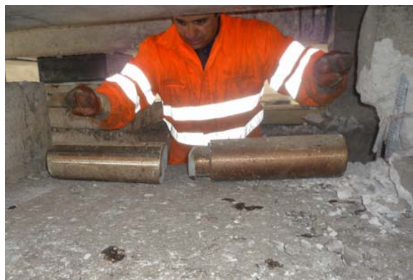
Bild 5.74: Viadotto San Sisto: Versagtes Rollenlager (KB_P343)
