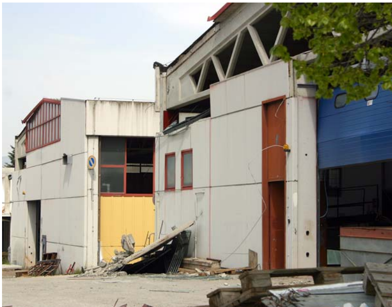
Bild 7.19: Abgefallenes Fassadenelement eines Industriegebäudes im Stadtgebiet von L'Aquila nahe des Bahnhofs (AD0075)
