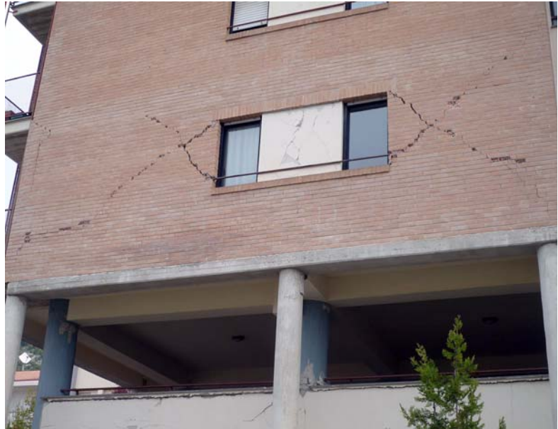
Bild 7.18: Typische kreuzförmige Rissentwicklung bei Erdbebenbeanspruchung in Klinkerfassade eine Mehrfamilienhauses im nördlichen Stadtgebiet von L'Aquila (FBR_P1000276)
