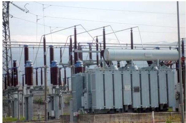
Bild 7.25: Unterwerk im Industriegebiet in Bazzano östlich von L'Aquila (FBR_1000064)
