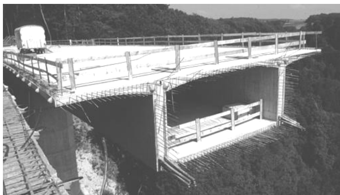
Figure 1.1 : Pont en encorbellement pendant sa construction (pont de la Mentue, AI, VD, 1998) avec vue de la dalle de roulement
