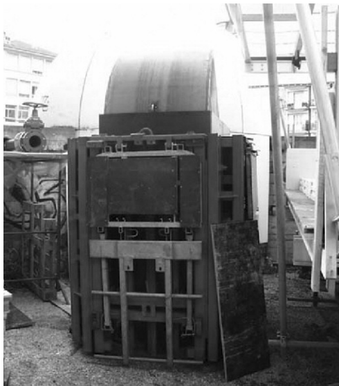
Figure 13 : Volume plongeur installé sur le bassin amont
