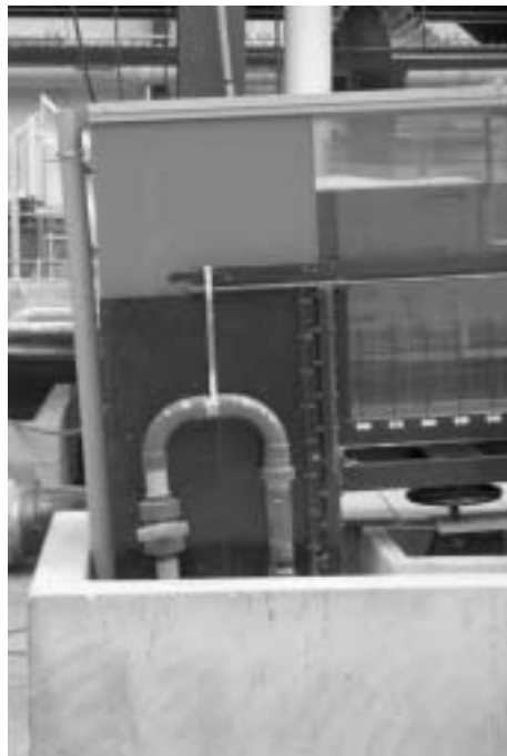
(d) Outlet valve of flume.
