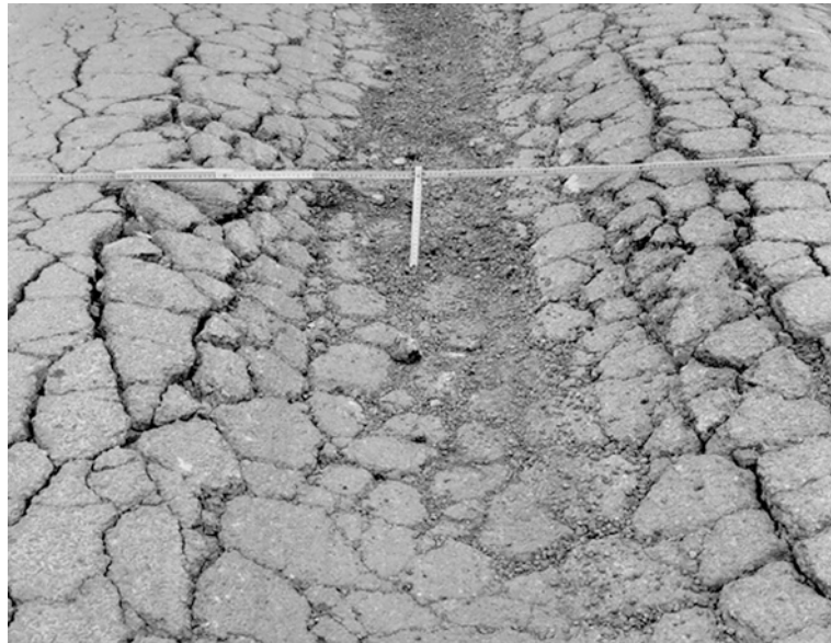
2-16 Poinçonnement d'une route lors du dégel (hiver 1962-63)
